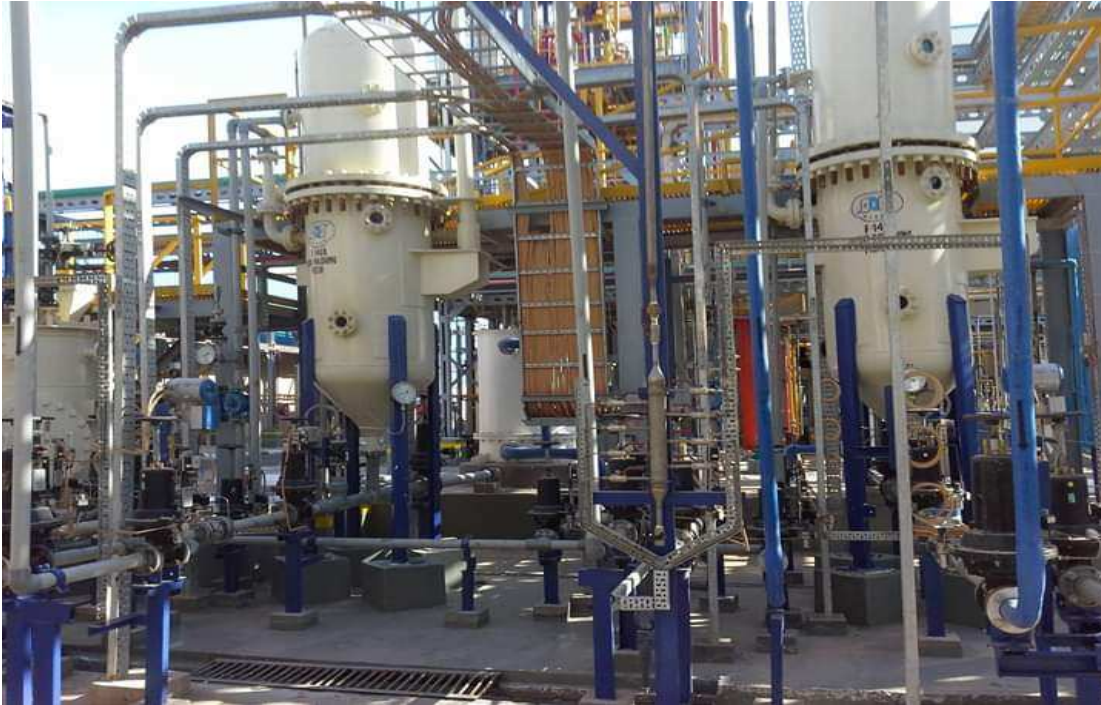
Figure I. 7 : Filtres de polissage A/B.
