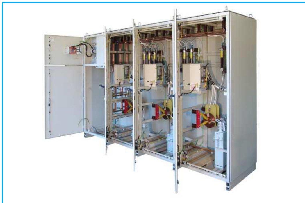
Figure I.10 : Exemple de batteries de condensateur utilisé dans réseau électrique. [8]
