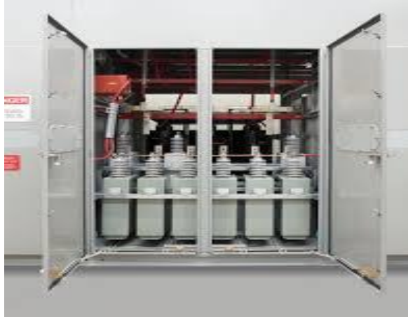
Figure II.8 : batteries de condensateurs moyenne tension. [17]
