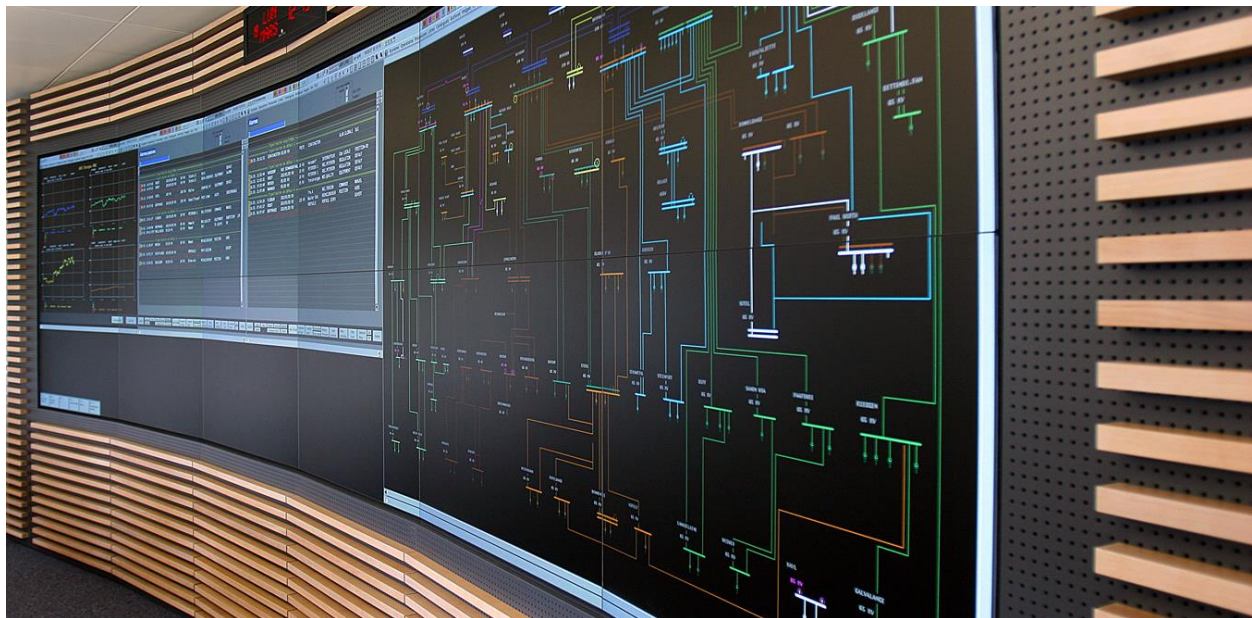
Figure II. 11 : salle de commande de système SCADA.
