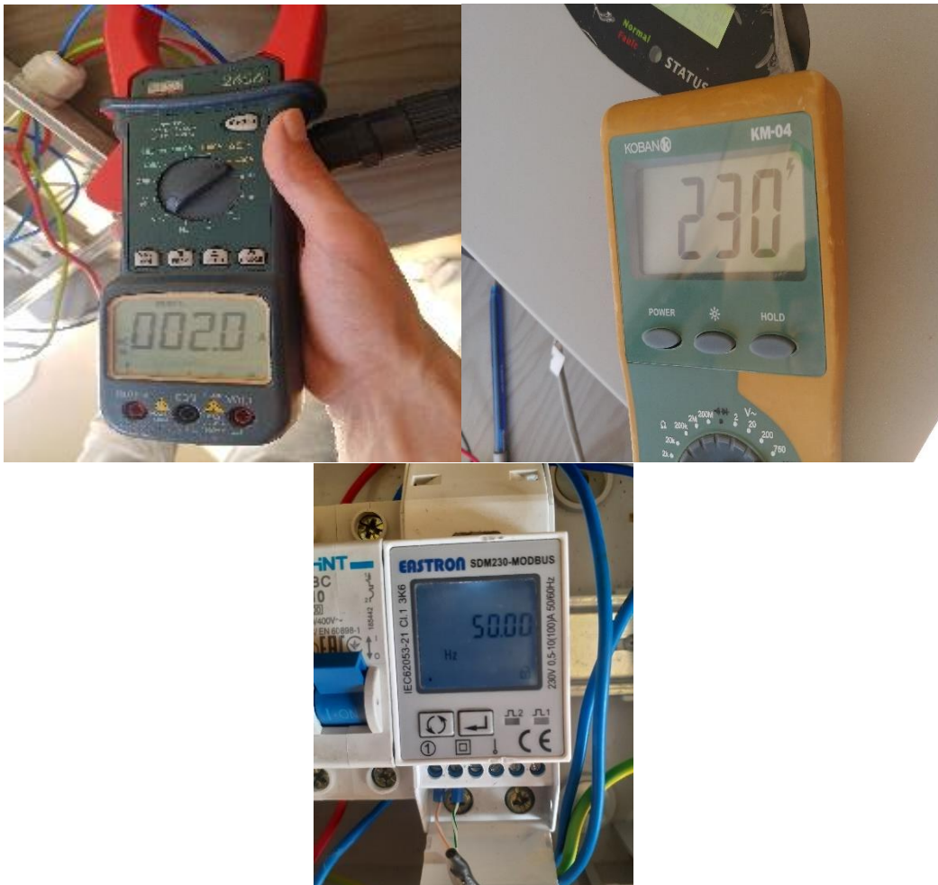
Figure IV-11: Les mesures sur le côté AC (onduleur).
