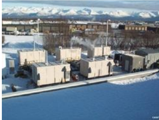
Figure 22: Cinq systèmes de piles à combustible UTC (PureCell™ 200, 200 kW) en Alaska, USA
