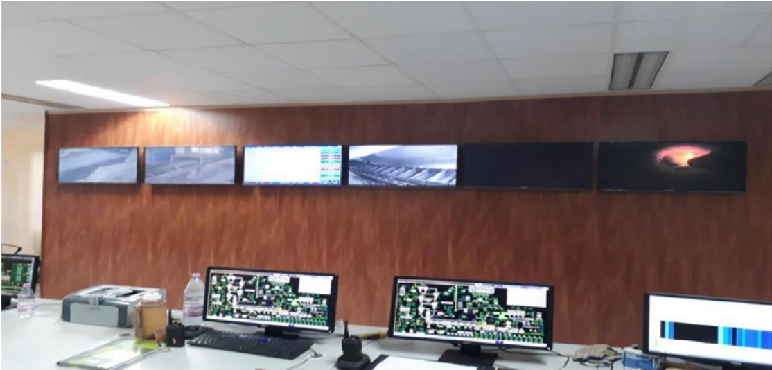
Figure I. 15: La salle de contrôle.
