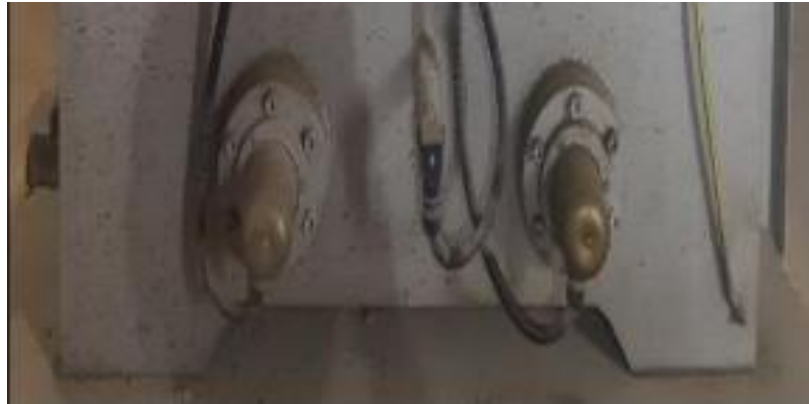
Figure III. 6: Le Chauffage électrique.
