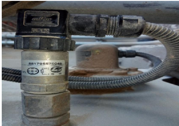
Figure III. 10: Capteur de température.
