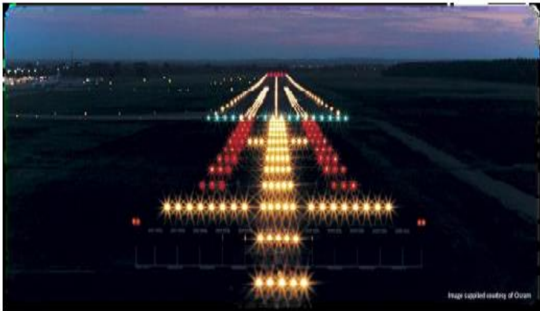
Figure 8.5. Balisage lumineux sur une piste d'aérodrome
