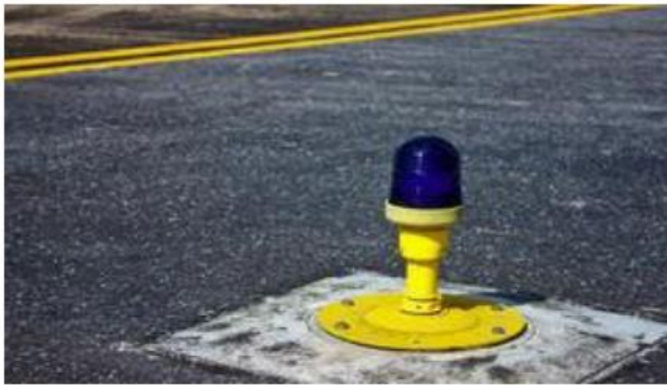
Figure 8.7. Balisage lumineux des voies de circulation
