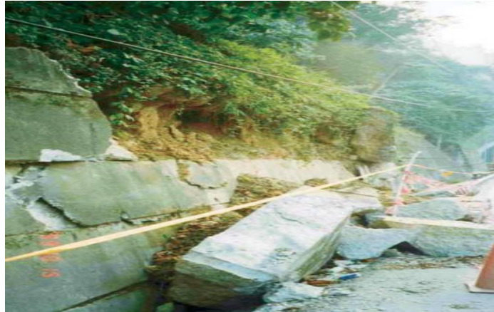
Figure II.10: Mouvement vers l'extérieur de mur gravitaire le long du joint de construction.
