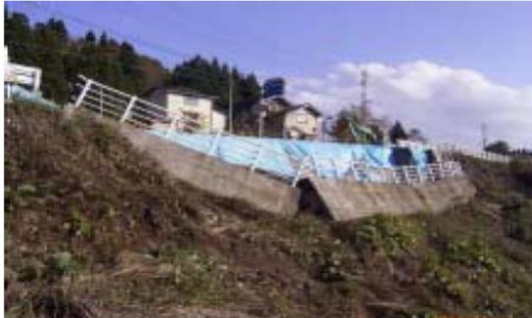
Figure II.8: Dommages causés à un mur de soutènement. Niigata-Ken Chuetsu 2004.
