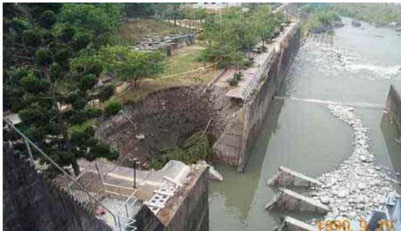
Figure II.9: Rupture de mur du barrage de Shin-Kang séisme de Chi-Chi 1999.
