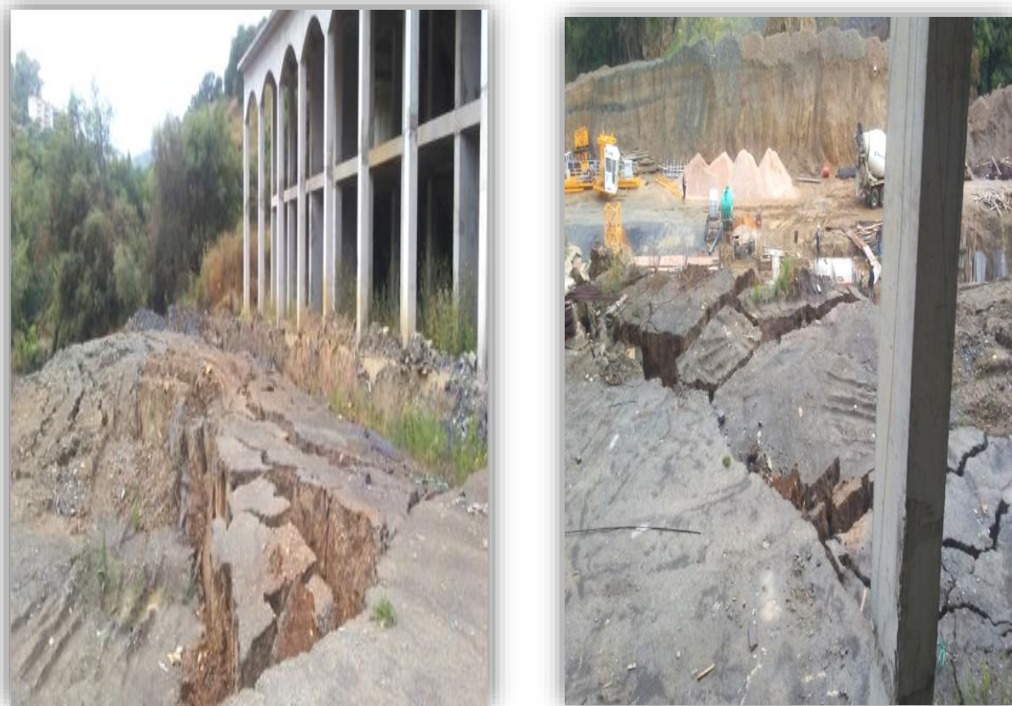
Figure II. 5 Fissures et effondrement des terrains (morphologie du glissement).
