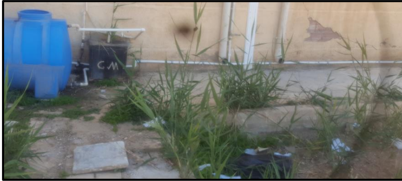
Photo III 10 Apparition de végétations (indice de longue période d'infiltration d'eau)
