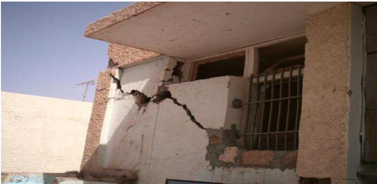
Figure I-33 Fissure sur les murs provoqués par des argiles gonflantes (Zenkri ,2010).
