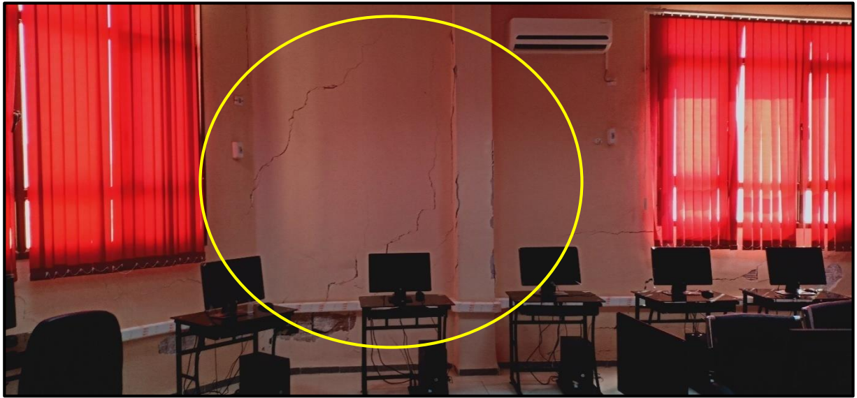
Photo III 17 Détérioration des murs en maçonnerie dans la salle d'internet
