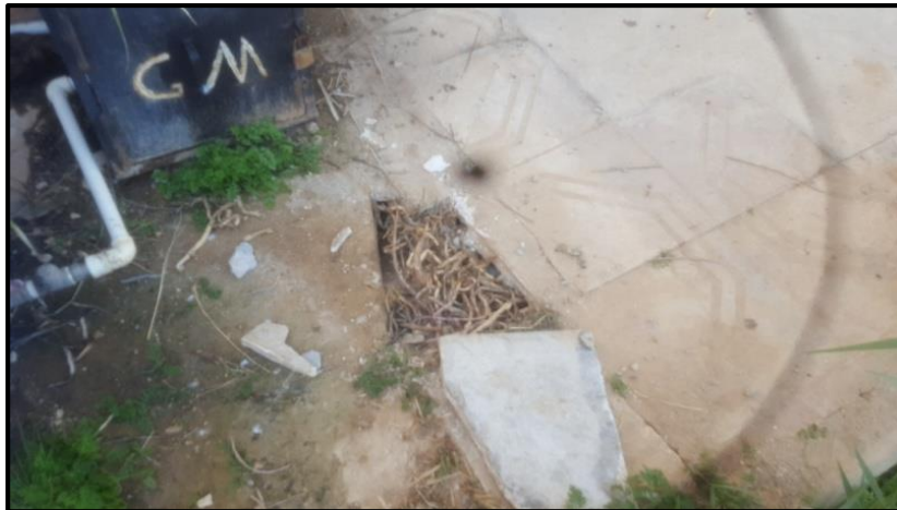
Photo III 11 Les racines des arbres et les plantes ont provoqués l'éclatement et gonflement des carrelages de trottoir
