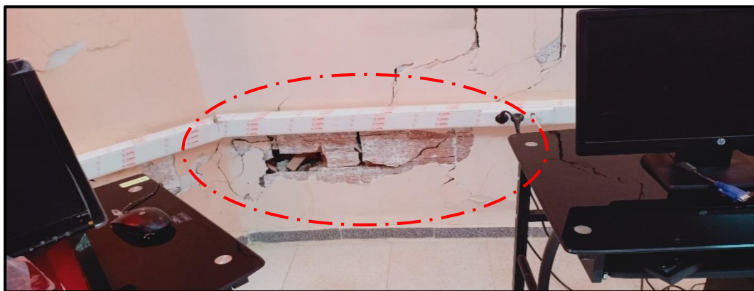
Photo III 12 Décollement de l'enduit et éclatement d'une partie d'un mur dû à un tassement différentiel
