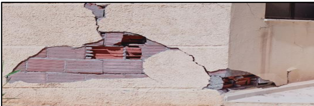
Photo III 5 Éclatement de mur en maçonnerie
