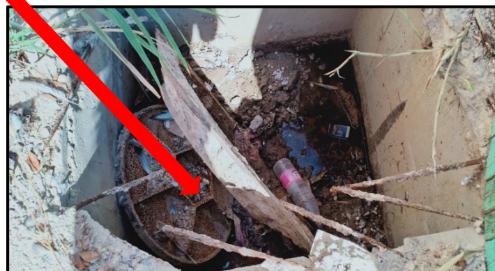
Photo III 9 Dégradation d'un regard des eaux usées et même la conduite branchée aux toilettes du centre
