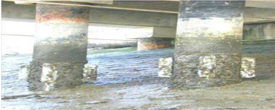
Figure I-10 Pathologie des pieux due à l'attaque sulfatique (Khial, 2016)
