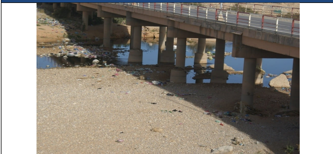
Affouillements autour des piles mal entretenues
