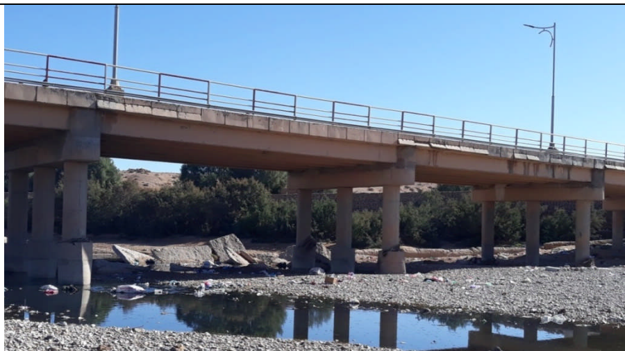
Piles colonnes mal entretenues (chemisage par treillis à souder), dégradation généralisée des corniches et infiltration des eaux au niveau des poutres de rive
