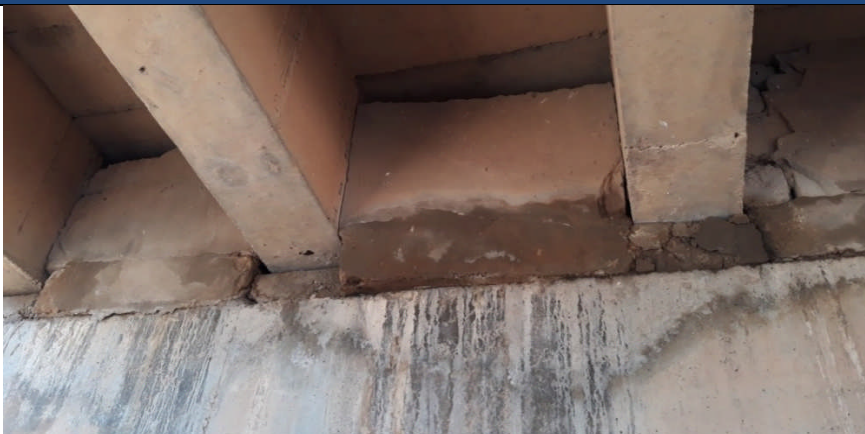
Détérioration du mur en parpaing surmontant les chevêtres et accumulation des eaux pluviales
