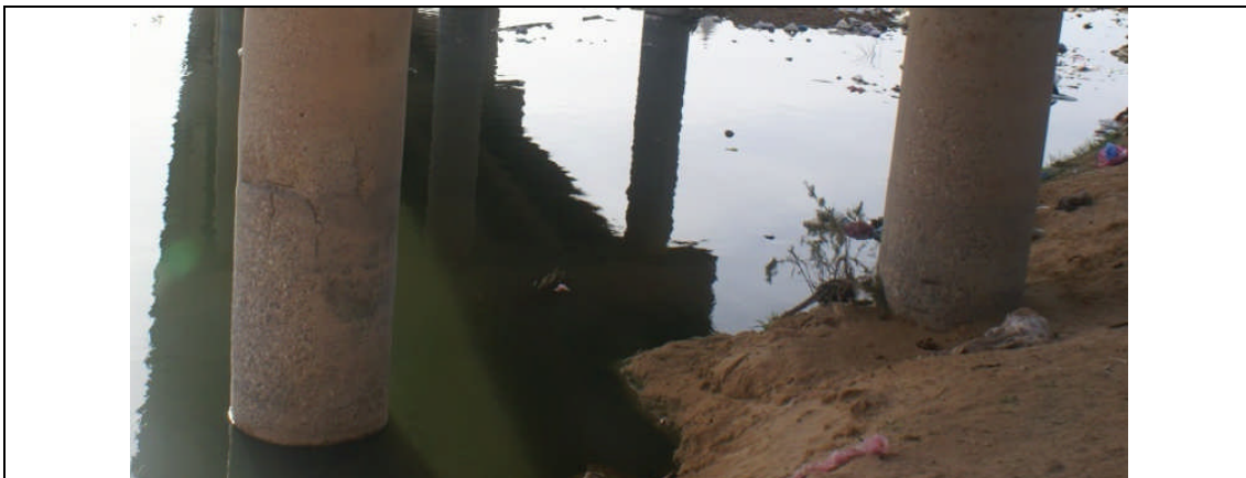
Corrosion des armatures et dégradation de béton
