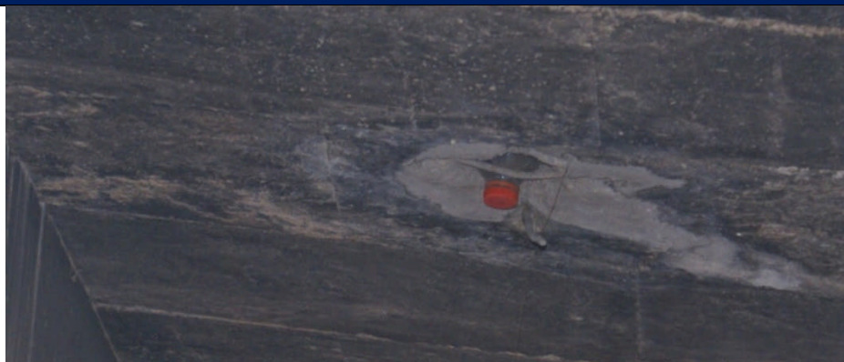
Obstruction des gargouilles
