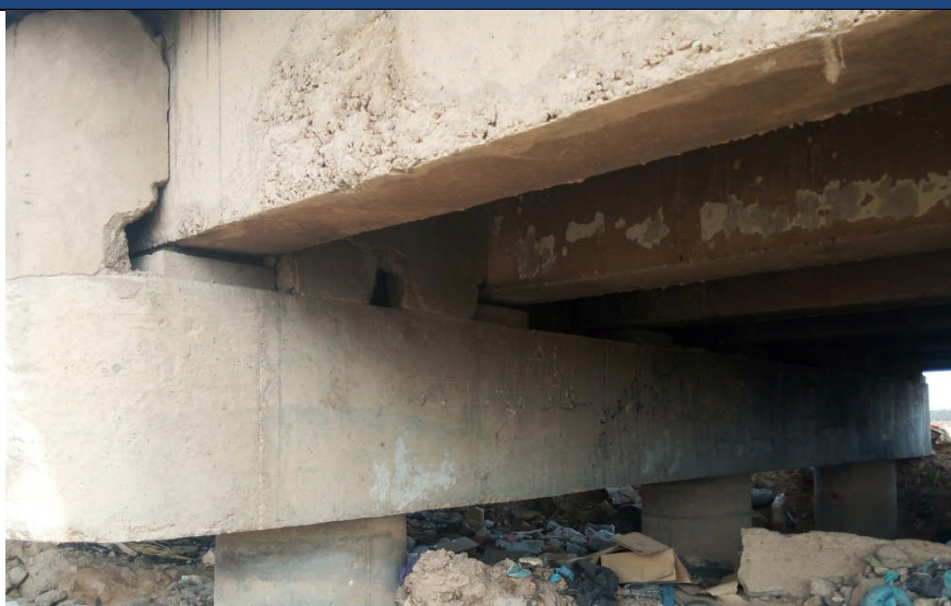
Ségrégation de béton au niveau des poutres
