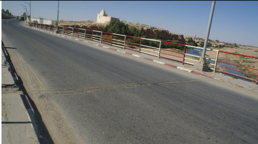
Joint de chaussées inexistant , leurs emplacements sont colmatés par du Béton bitumineux
