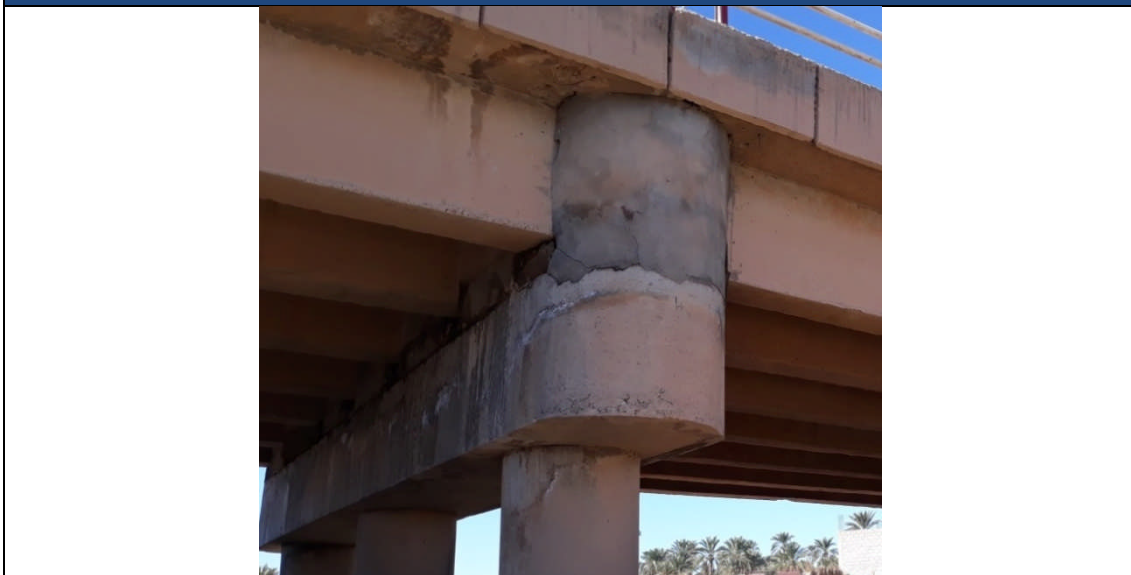
Infiltration des eaux au niveau des joints de chaussées et trottoir, efflorescence observée au niveau du chevêtre et de la partie supérieure de la pile
