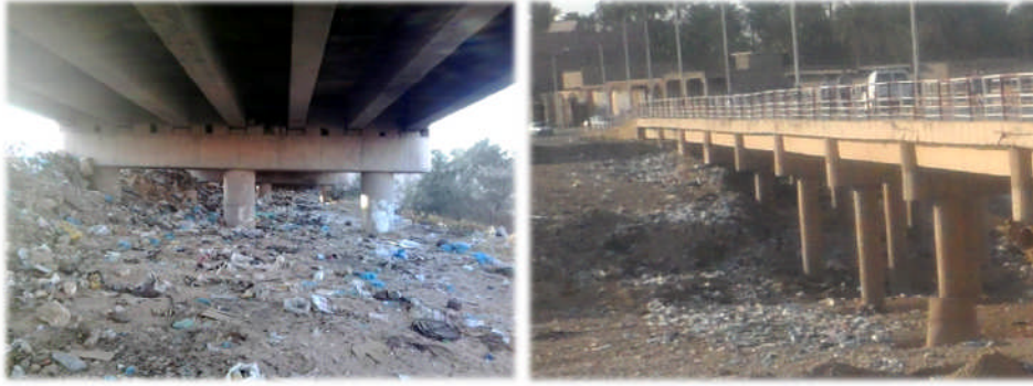
Dépôts illicites et quatre travées obstruées par des dépôts de terre et ordures ménagères
