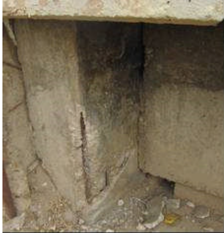
Photo 8 : Dégradation des culées accélérée par l'infiltration des eaux ; Insuffisance de l'enrobage des culées et des fûts des piles.
