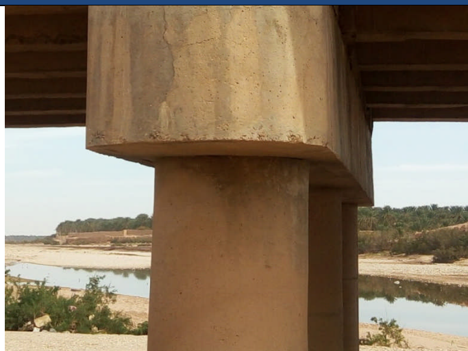
Apparition de quelques fissures au niveau du chevêtre
