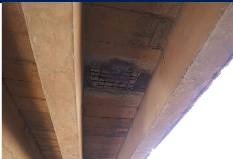
Dalettes(coffrage perdu)degradée en dessous de la dalle
