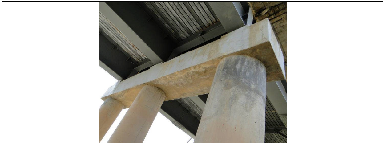
Fissuration en maille des parements du chevêtre. Zones sonnant le creux. Ces désordres doivent avoir pour origine une réaction de gonflement qui est déchaînée par l'écoulement d'eau sur le béton, provenant du joint de chaussée
