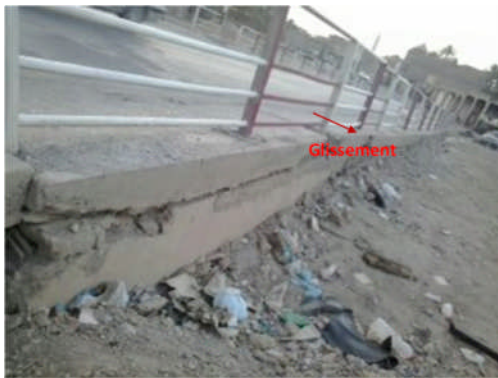
Cisaillement / fracture entre le mur de soutènement et le trottoir
