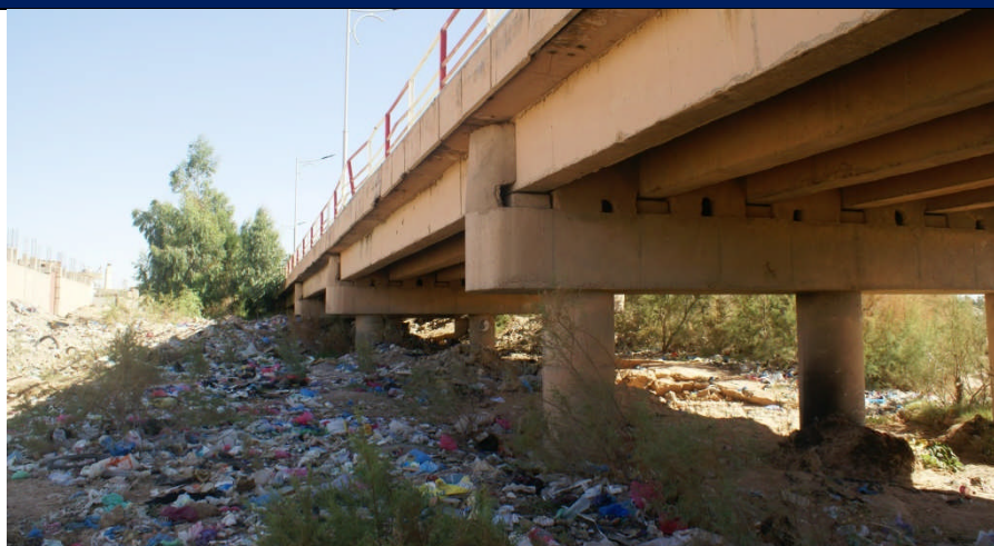
Quatre premiers travées coté Ouled Djellal sont obstruées par des terres et ordures
