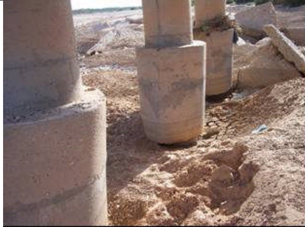
Photo 4 : Affouillement grave le long du lit de l'oued et autour des piles.
