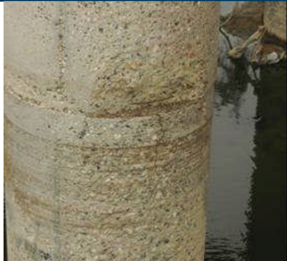
Photo 10 : Insuffisance de l'enrobage des culées et des fûts des piles.
