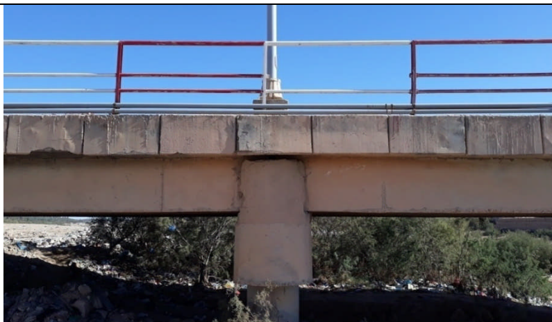
Dégradation des corniches et du garde-corps
