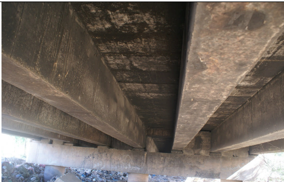
Travée carbonatée a cause des fumées et incendies
