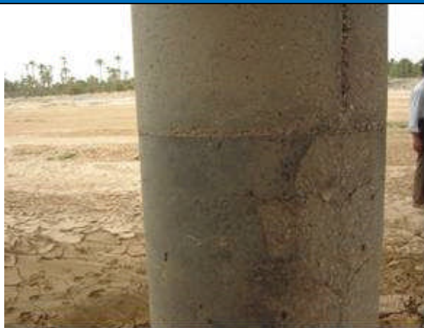
Photo 11 : Présence de fissures longitudinale et transversale sur les fûts.
