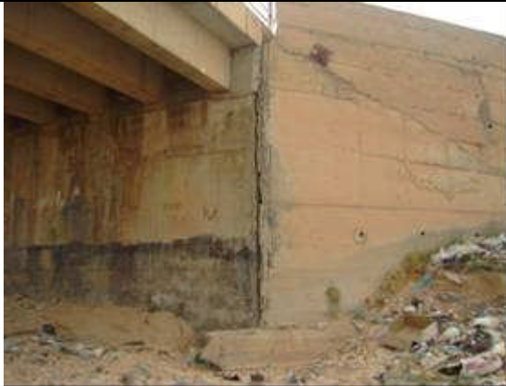
Photo 6 : Ouverture du joint culée-murs en aile non solidaire ; Trace de venus des eaux de ruissèlement à travers les joints de chaussée sur les culées.
