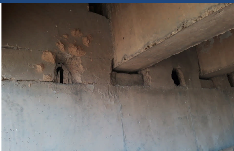
Murettes en parpaings surmontant les chevêtres et culées gênant les déplacements verticaux des travées
