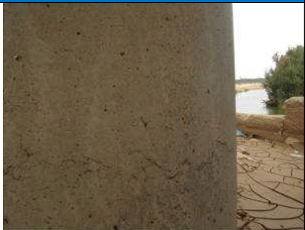
Photo 12 : Présence de fissures longitudinale et transversale sur les fûts.
