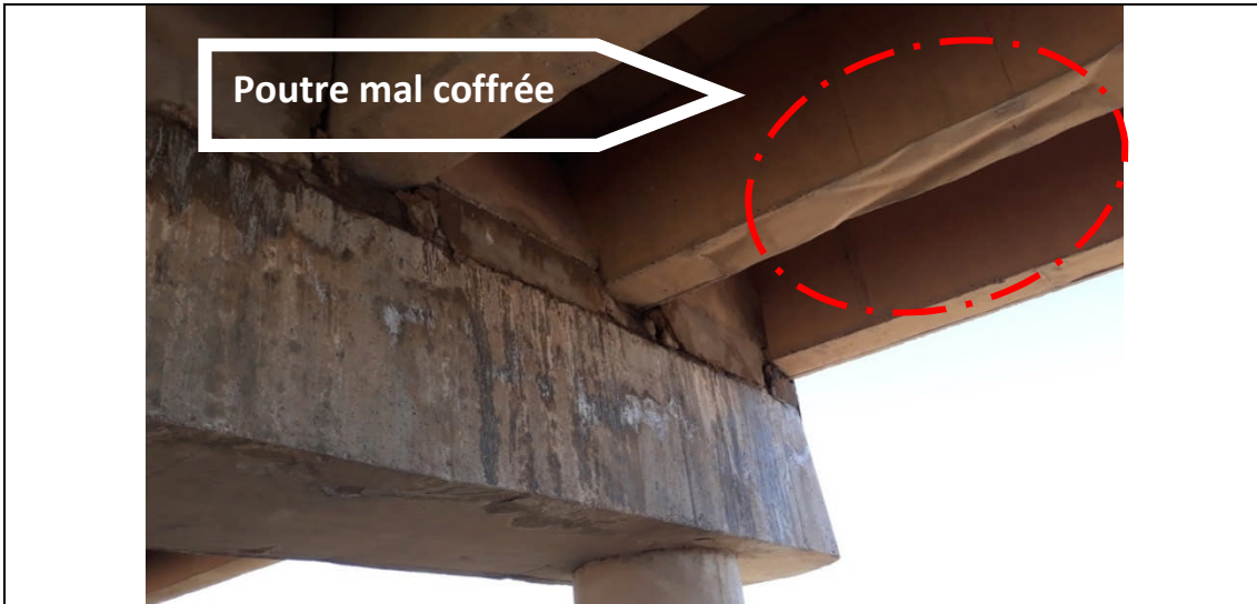
Des poutres mal coffrées ; efflorescence et infiltration des eaux
