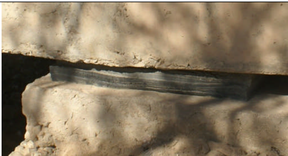
Appareil d'appui usé
