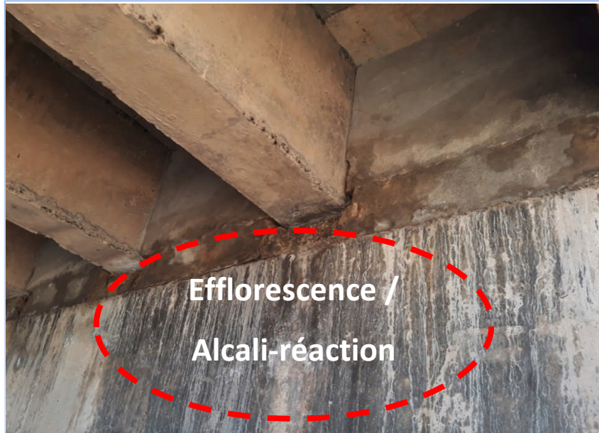
Accumulation des eaux au niveau du chevêtre, efflorescence
