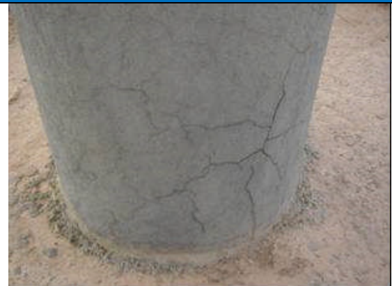
Fissuration en maille de la zone qui a été réparée par un mortier de ciment.
