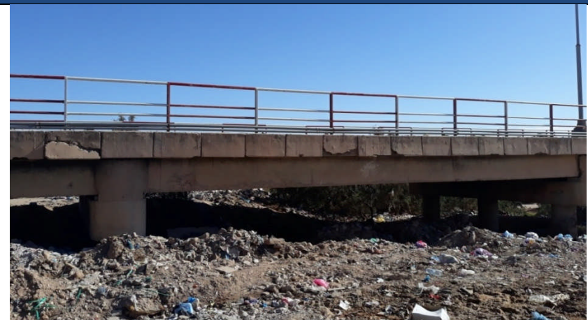
Détérioration généralisée des corniches
