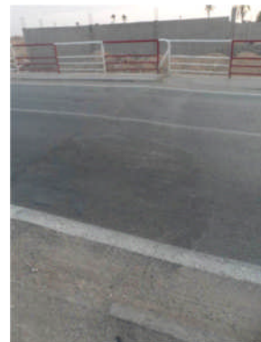
Affaissement de la chaussée au droit du remblai d'accès
