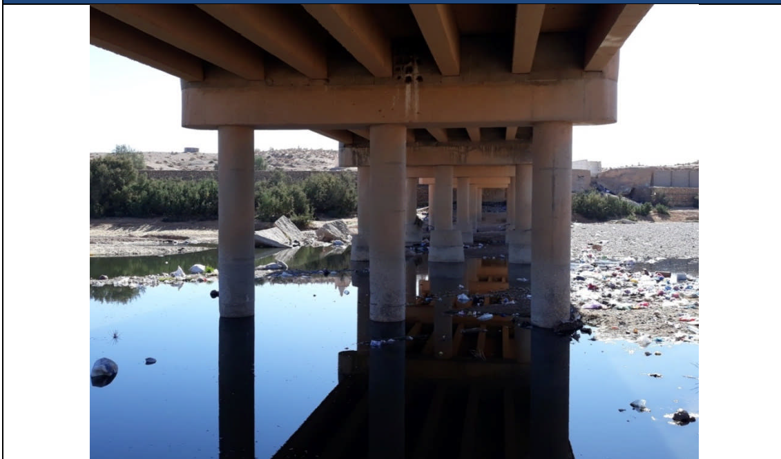
Milieu agressif et apparition des armatures transversales (cerces des piles)
