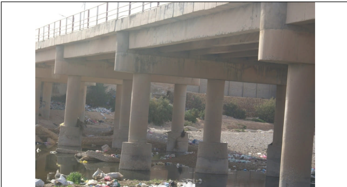
Réhabilitation mal conçue techniquement et esthétiquement
