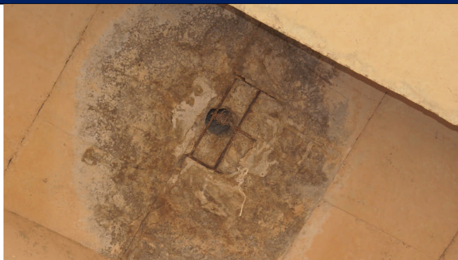
Dallettes préfabriquées dégradées et système de drainage défectueux
