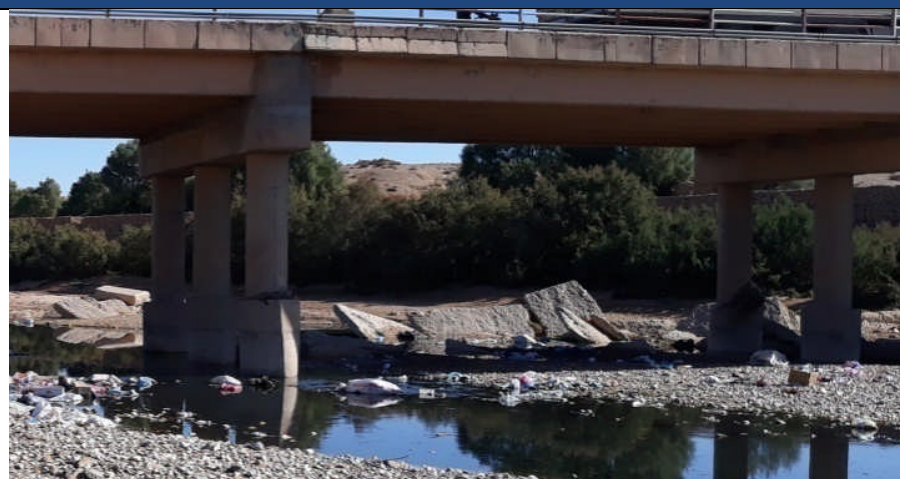
Piles colonnes mal entretenues
