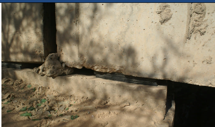
Appareil d'appui usé
