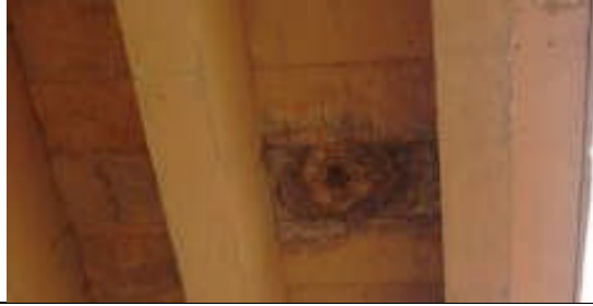
Photo 3 : Dégradation des dalles au voisinage des gargouilles.
