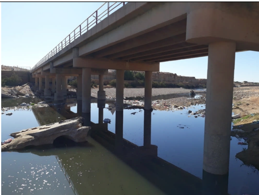
Dégradation des parties inférieures des fûts en contact avec les eaux usées
