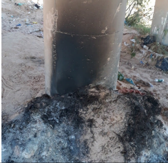
Dégradations à cause du feu
