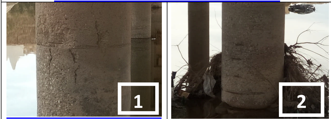
Eaux usées-Apparition des armatures transversales corrodées
