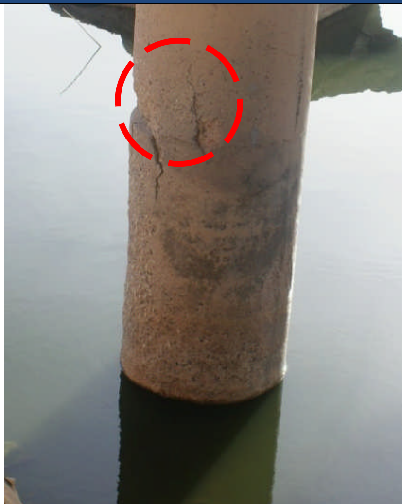
Dégradation et fissuration des fûts
