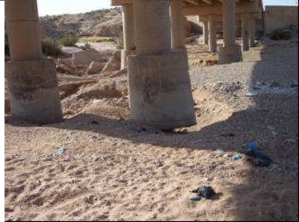
Photo 5 : Affouillement grave le long du lit de l'oued et autour des piles ; Présence de blocs en béton gênant l'écoulement.
