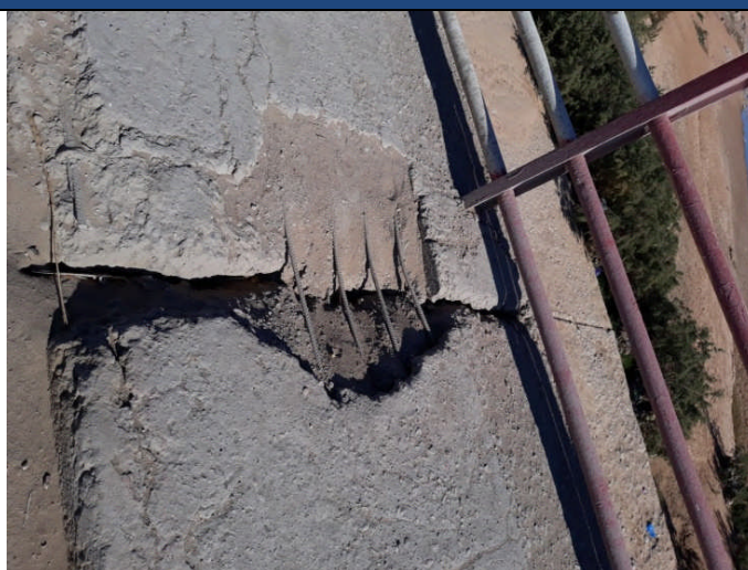
Dégradation des dalles de trottoir
