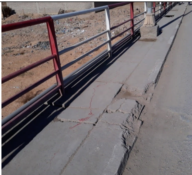
Dégradation des dalles de trottoir
