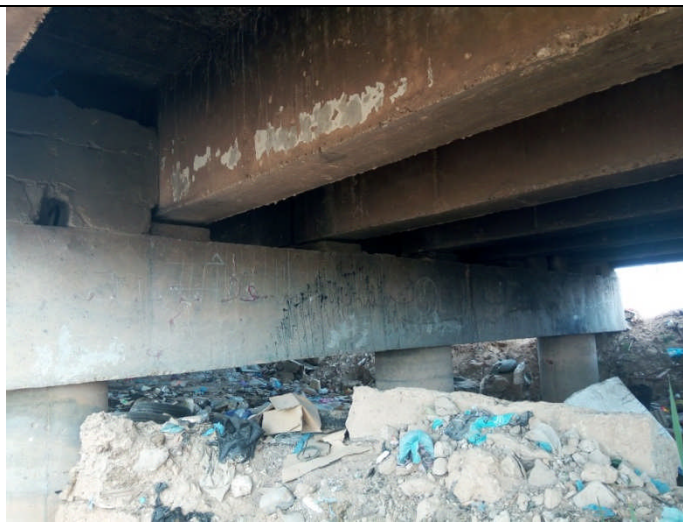
Dégradation au niveau des poutres
