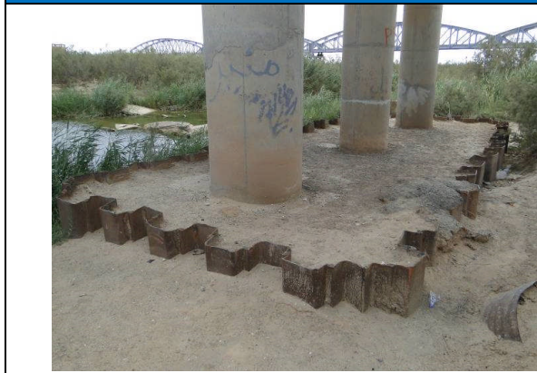
Semelle. Accumulation de débris sur la semelle.
