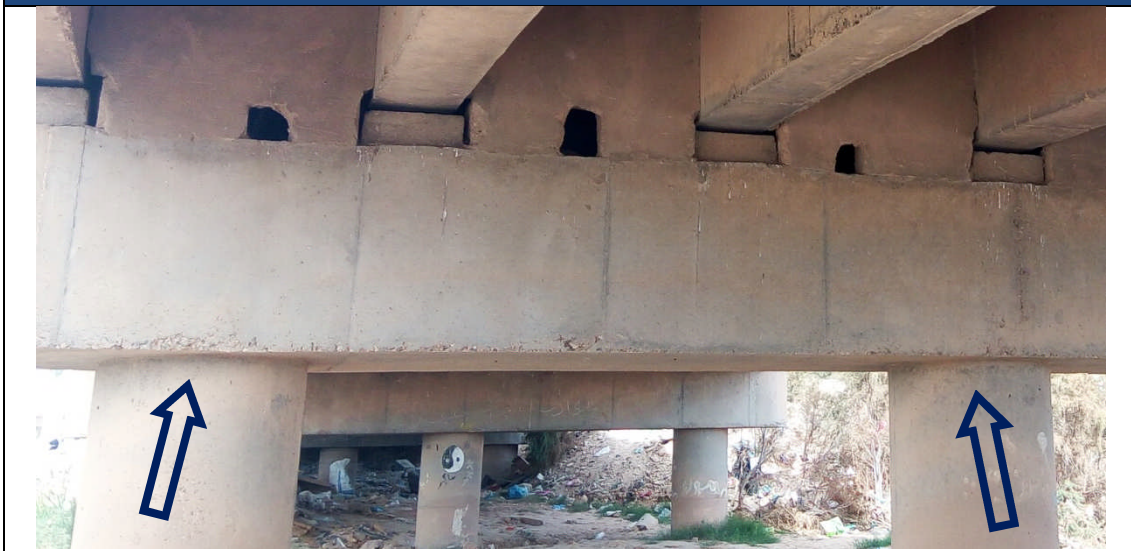
Chevêtres préfabriqués posés sur fûts : chevêtres et piles ne sont pas solidaires
