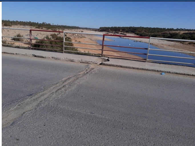
Dégradation des dalles de trottoir et manque de joint de chaussée
