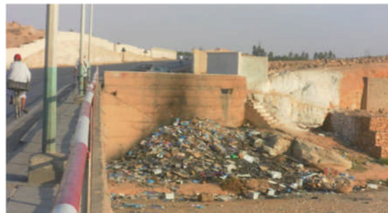
Dépôt illicite mur de soutènement côté Touggourt en amont de l'oued
