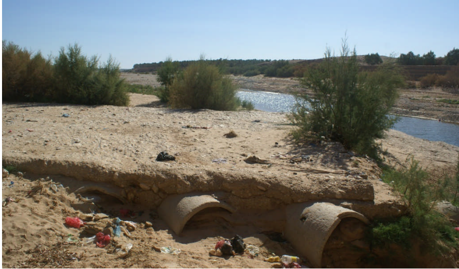
Le reste de l'ancien gué submersible , coté aval :un vrai obstacle pour l'écoulement des eaux
