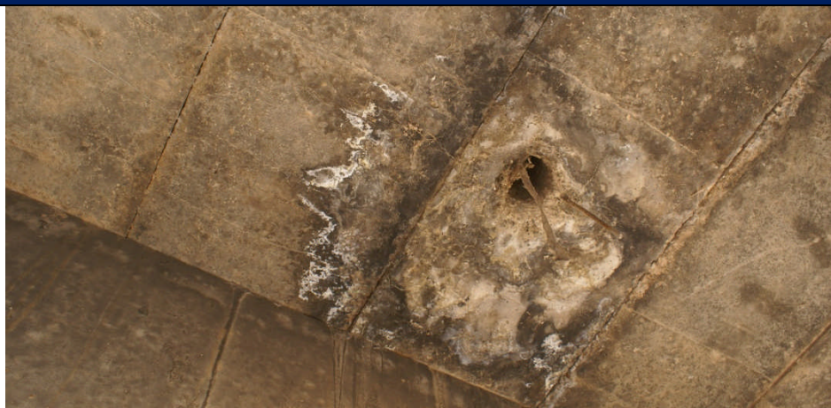
Obstruction des gargouilles
