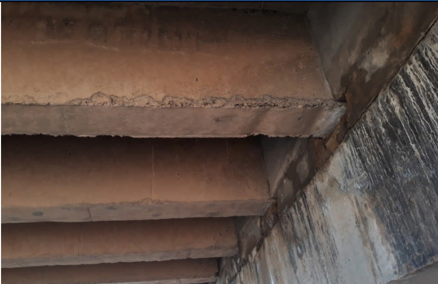
Accumulation des eaux au niveau du chevêtre, efflorescence et dégradation des poutres
