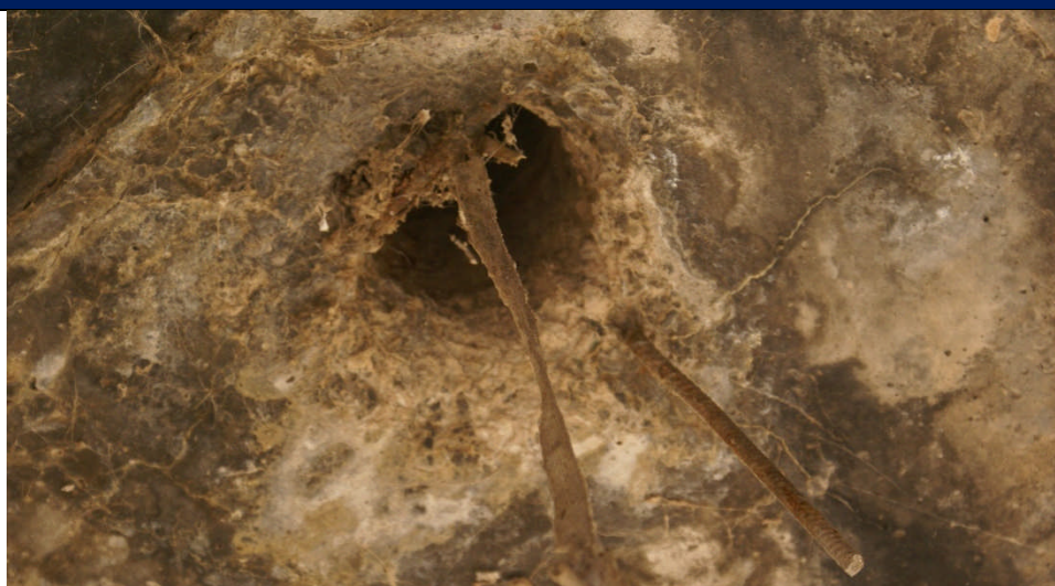
Detail gargouille Obstruée
