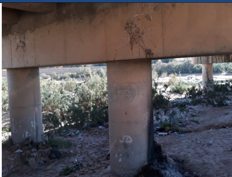
Ségrégation de béton au niveau de la partie inférieure des poutres
