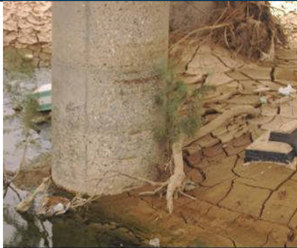
Photo 9 : Insuffisance de l'enrobage des culées et des fûts des piles.
