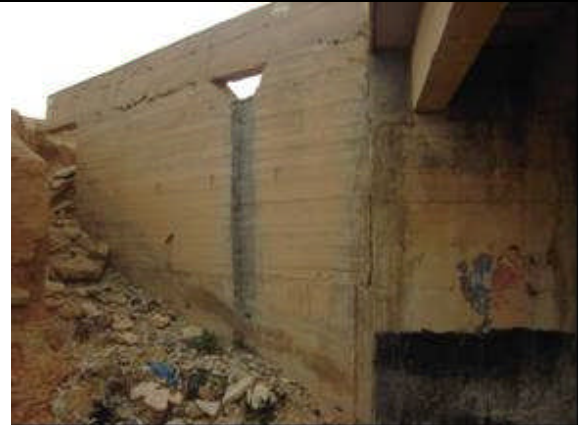
Photo 7 : Affouillement derrière des murs en aile ; Trace de venus des eaux de ruissèlement à travers les joints de chaussée sur les culées.
