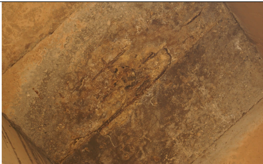
Dallettes(coffrage dalle perdu)dégradée en dessous de la dalle et infiltration des eaux
