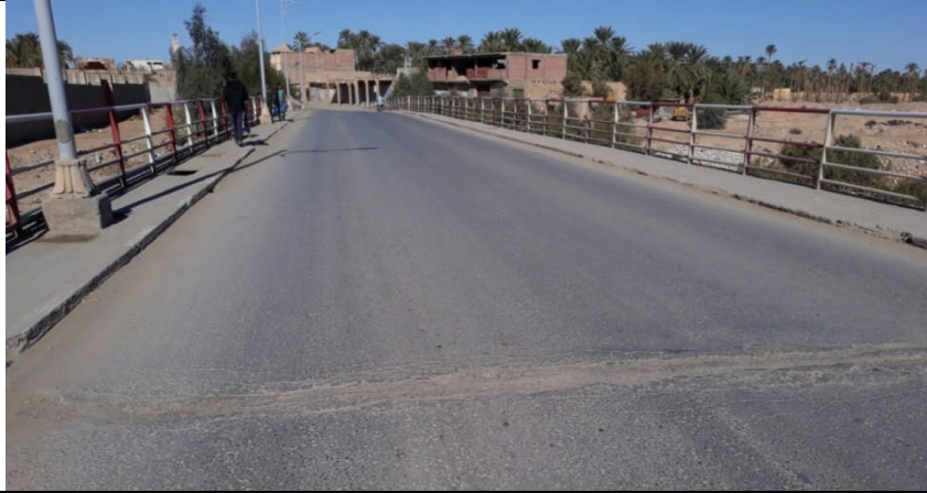
Absence des joints de chaussées ou joints de dilatations
