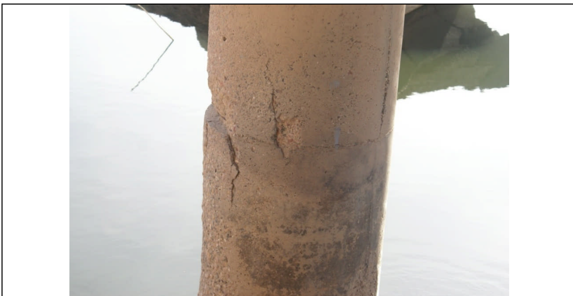
Dégradation et fissuration des fûts(Agrandissement)
