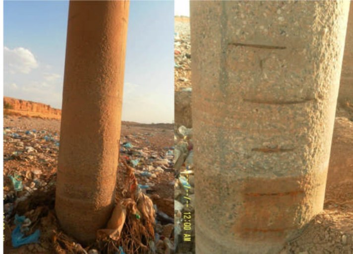
Erosion des colonnes jusqu'à apparition des armatures
