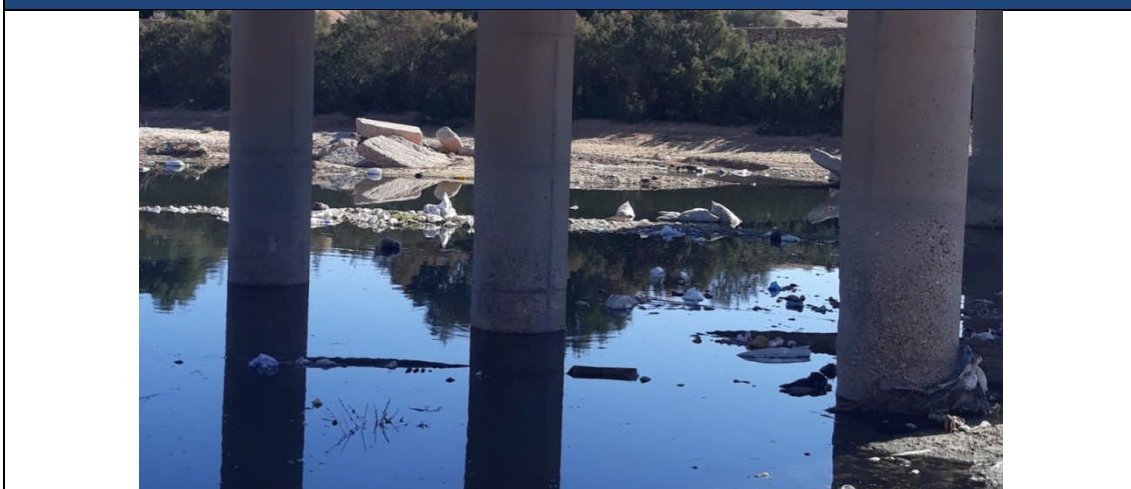
Dégradation et fissuration du béton des piles, eaux usées (attaque chimique)
