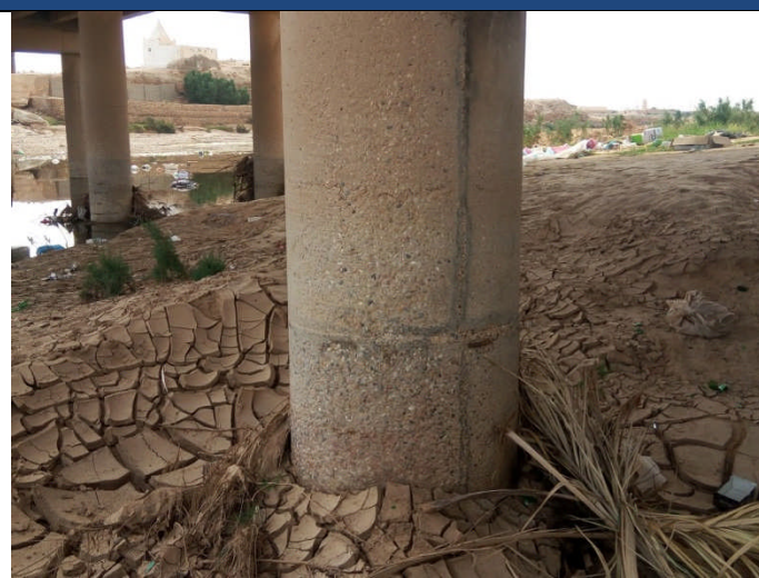
Erosion de béton et corrosion
