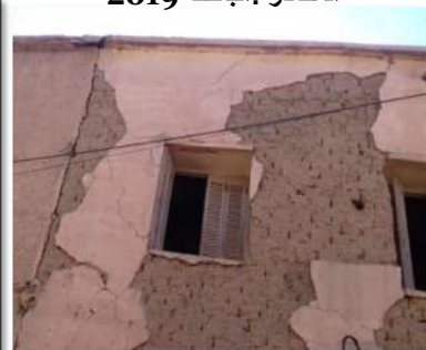
الصورة 105: سقوط تلييس الواجهة الخارجية المصدر: الباحث 2019
