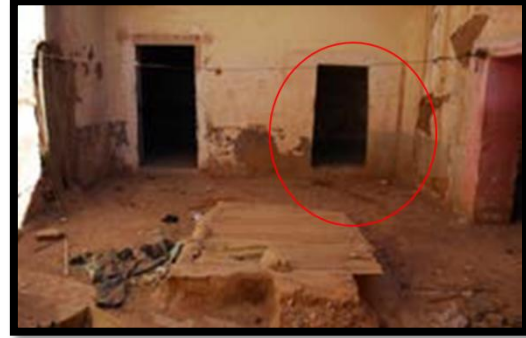
صورة رقم (77) : مبنى متضرر
