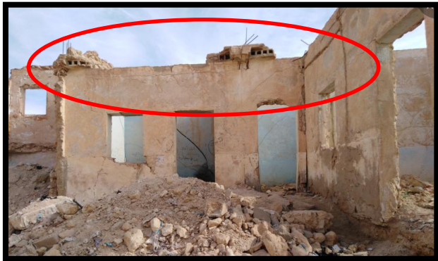
صورة رقم (46) :بقايا السقف المنهار المصدر: الطالب 2020
