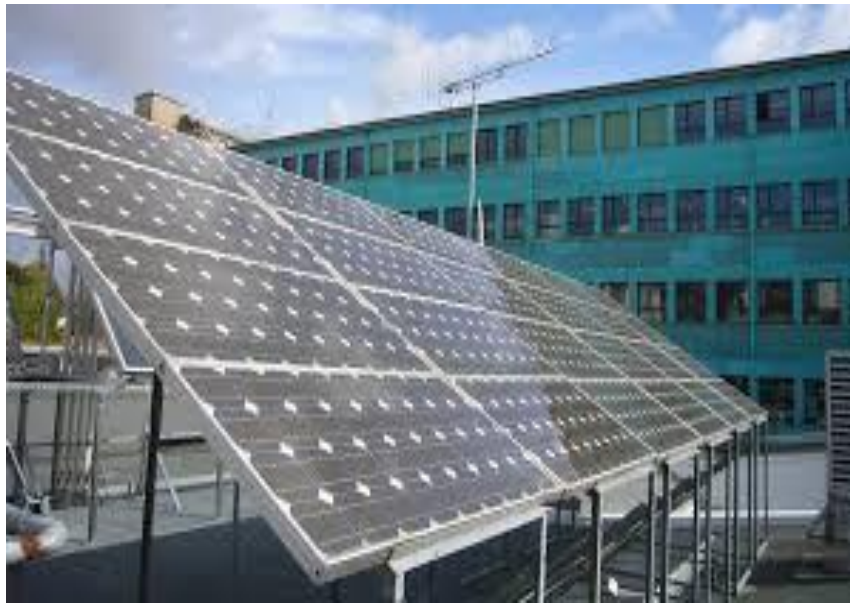
Figure 1.8. Les panneaux photovoltaïques.
