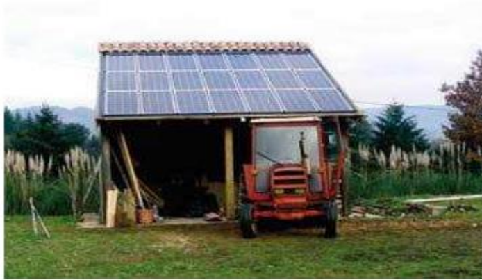
Figure 1.25. Intégration des capteurs solaires sur une dépendance.
