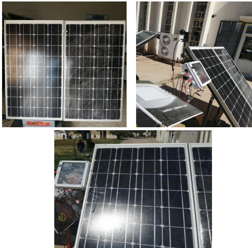
Figure III- 3 : L'installation finale du banc d’essai photovoltaïque.
