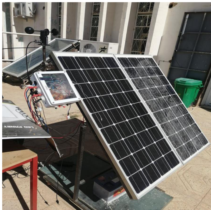
Figure II- 3 : L'installation finale du banc d'essai photovoltaïque.
