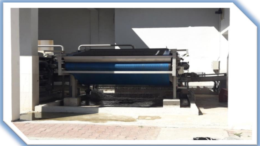
Figure 24 : Déshydratation des boues de la STEP d'Arris le filtre à bandes presseuse.
