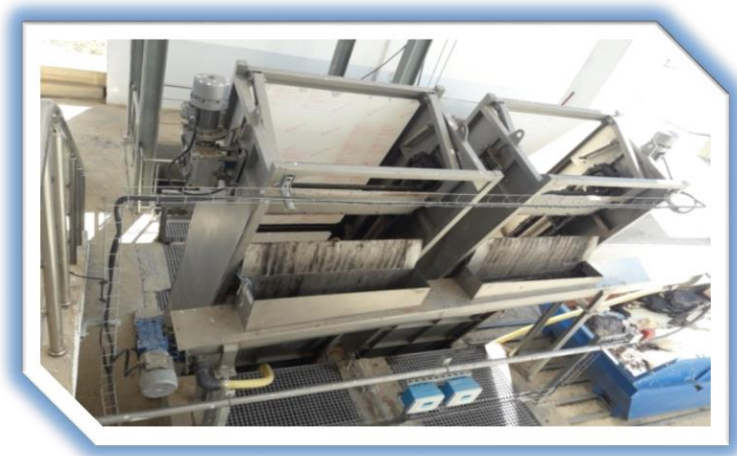
Figure 11 : Dégrillage grossier de la STEP.
