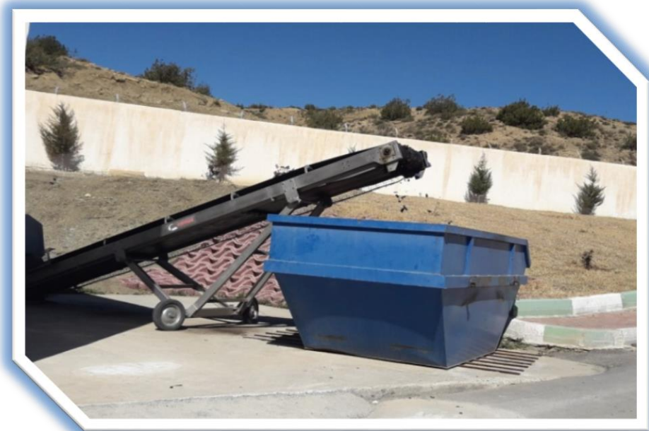
Figure 25 : Décharge des boues déshydratées en benne.
