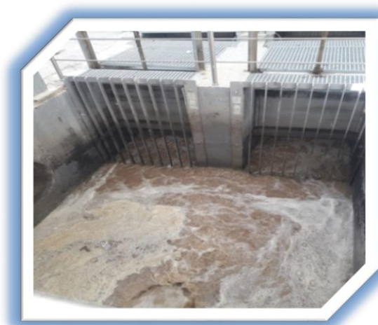
Figure 09 : Fosse à bâtard de la STEP.
