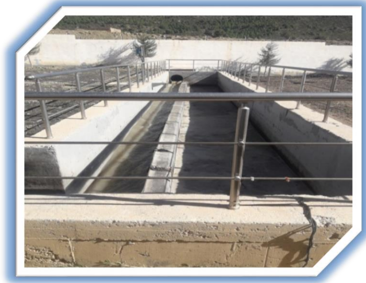
Figure 08 : Déversoir d'orage de la station d'Arris.
