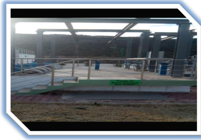
Figure 22 : Les groupes d'électropompes destinées pour le pompage des boues en excès et des boues de recyclage.
