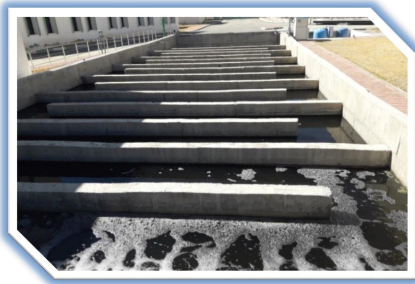
Figure 21 : Bassin de chloration.
