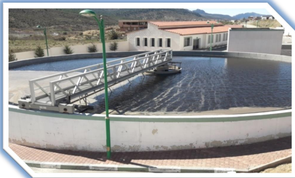
Figure 20 : Le décanteur secondaire.
