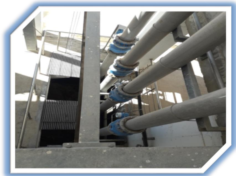
Figure 12 : Le poste de relevage et les pompes submersibles.
