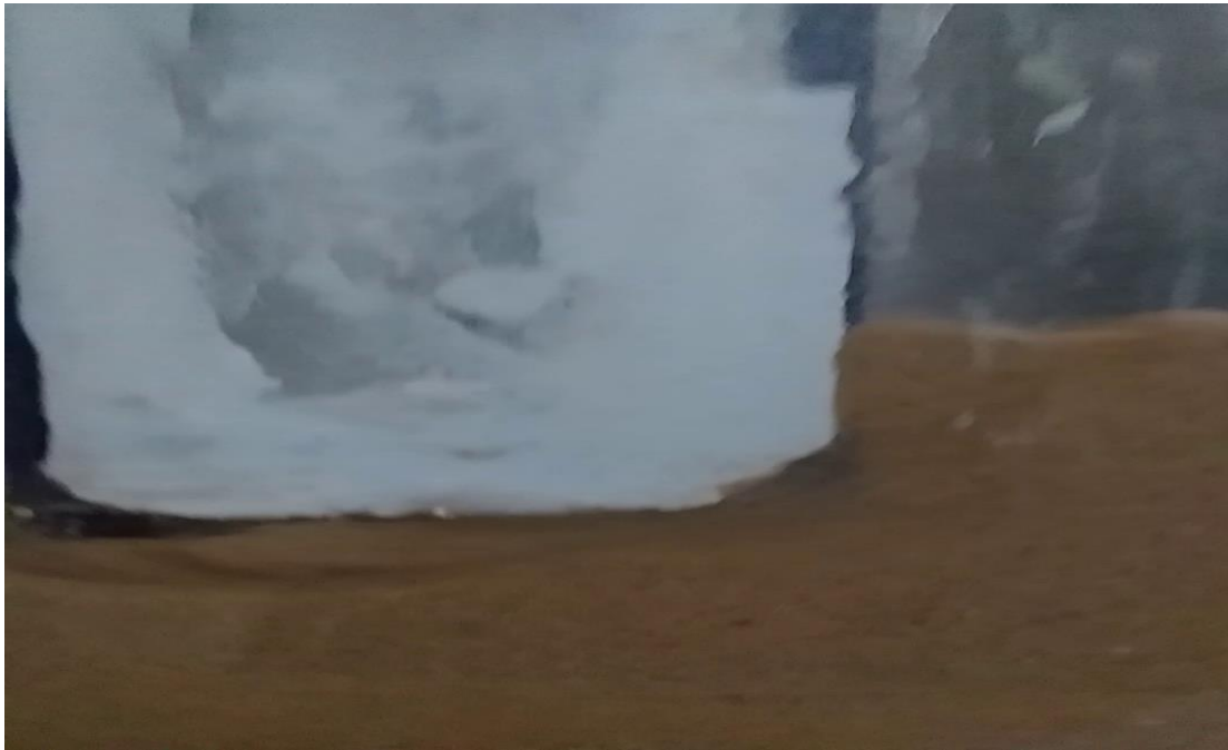
Figure III-13: Début de l'érosion au pied amont du barrage
