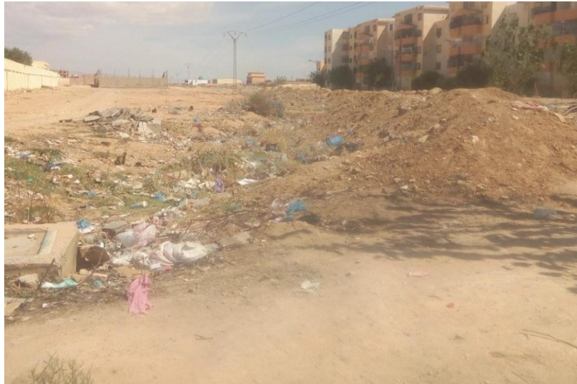
Fig.10. Envasement et obstruction du canal
