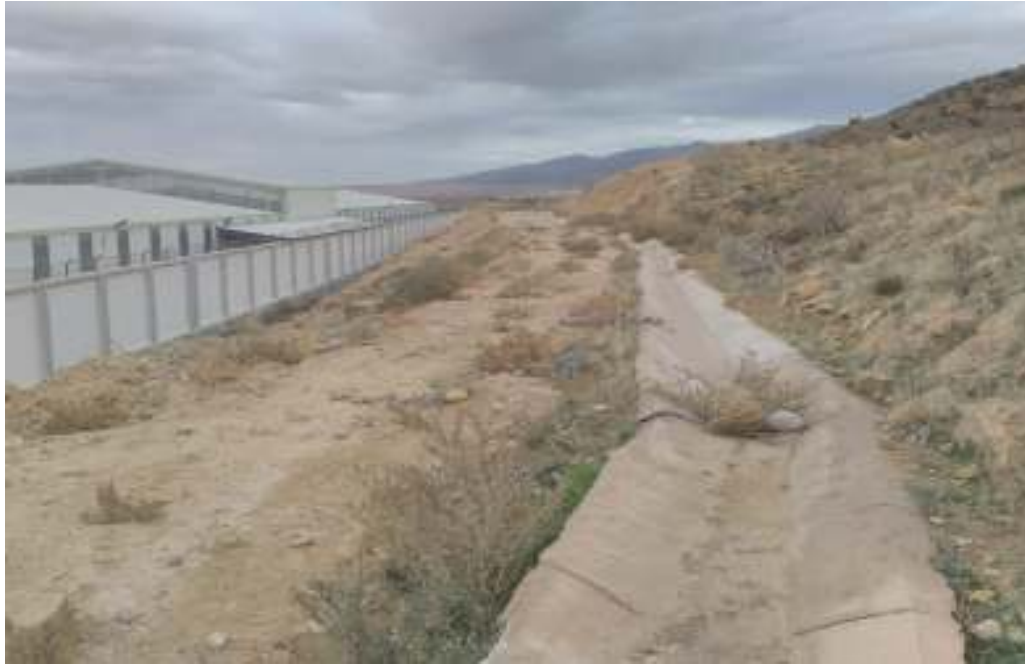
Fig 5 Point noir d'inondation (tronçon contre pente)
