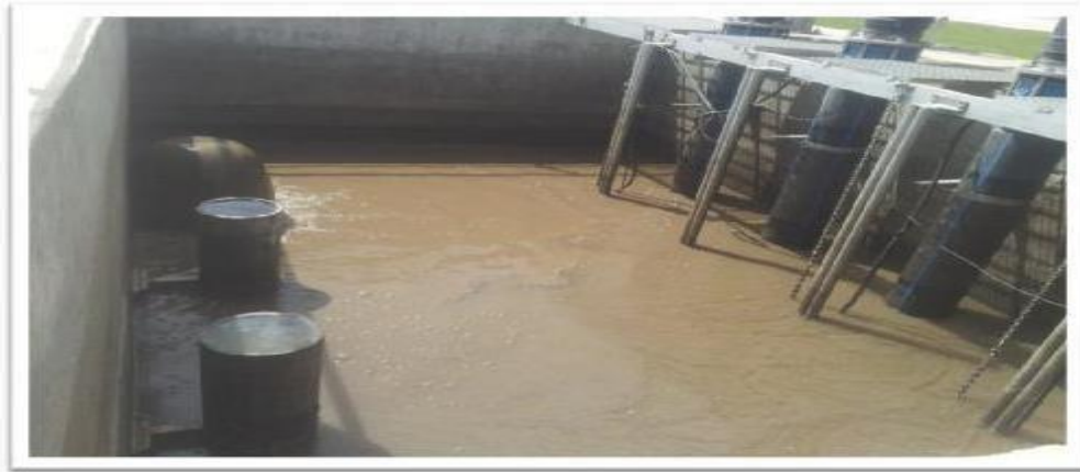
Figure 3.9: Pompage des boues
