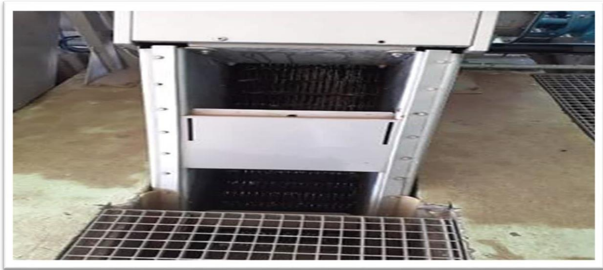
Figure 3.4 : Dégrillage mécanisé fin
