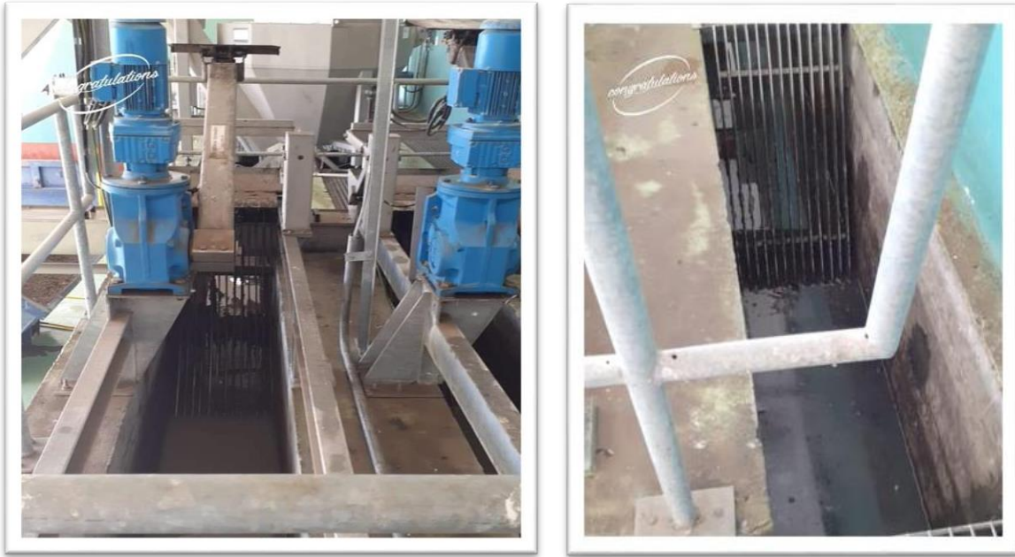
Figure 3.3: Dégrilleur mécanique grossier
