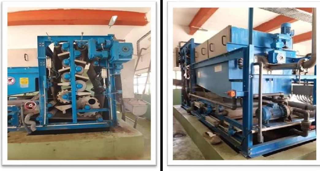
Figure 3.11: déshydratation mécanique à filtre presse à bande.
