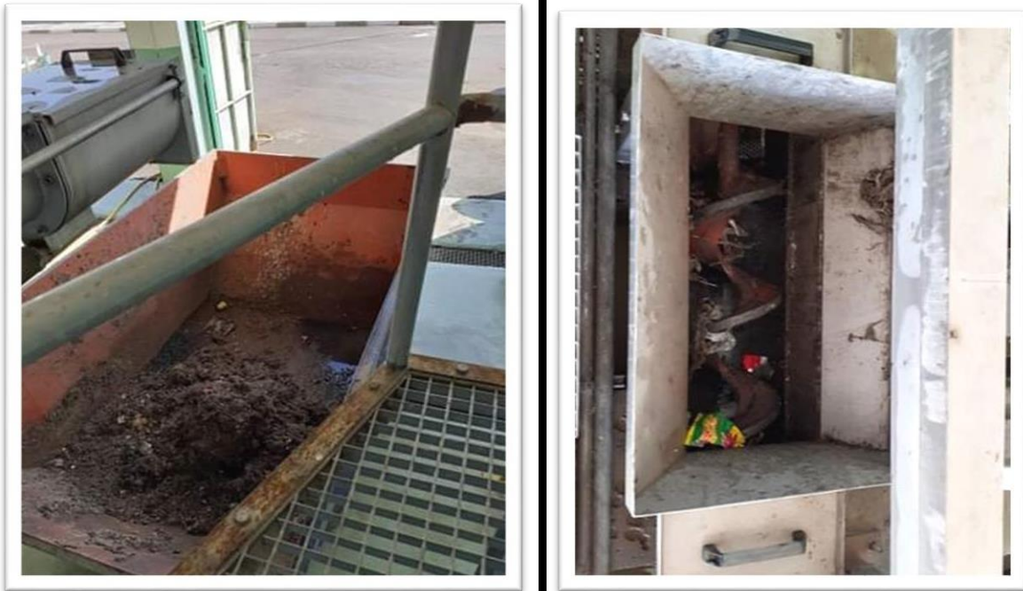
Figure 3.5 : Les refus de dégrillage
