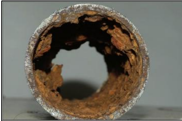
Figure I.2 : Coupe transversale d'une pipeline après l'attaque de corrosion par un acide fort [7].
