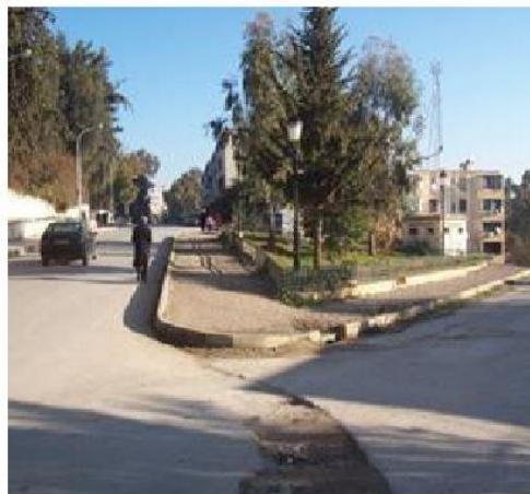
Figure 2.35 : dégradation de la chaussée après une année de sa réalisation
