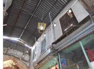
صور 88 تبين اضرار المبنى و مشاكل الطوب
