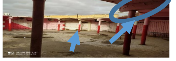
صورة رقم 76 تظهر اعراض الرطوبة المصدر : المؤلف
