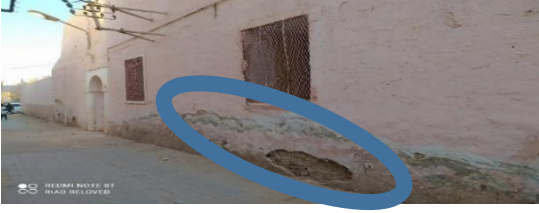
صورة رقم 77 تظهر اعراض الرطوبة المصدر : المؤلف
