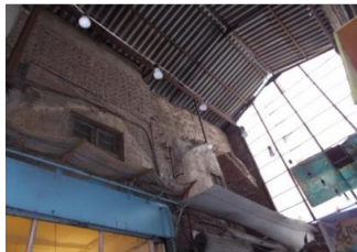
صور 89 تبين اضرار المبنى و مشاكل الطوب
