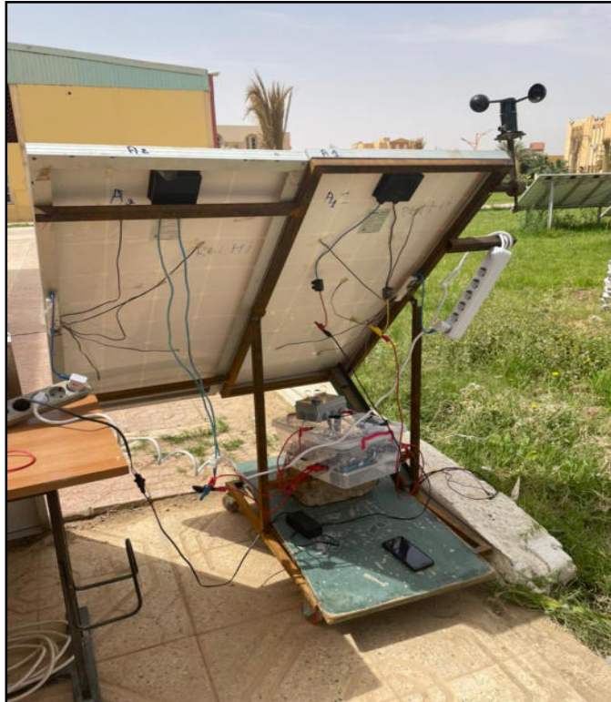
Figure II.19a : Montage system Arduino sur Panneau
