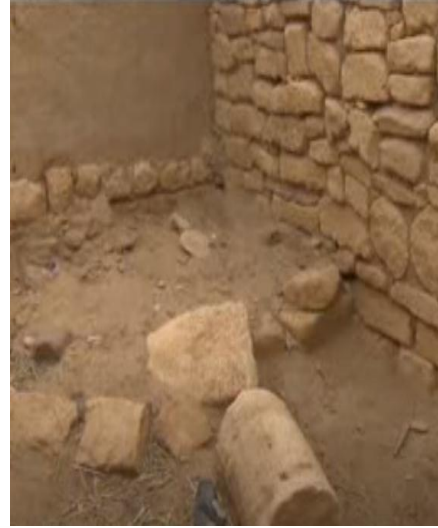
الشكل (01) صورة لجدار وأعمدة متساقطة على الأرض
