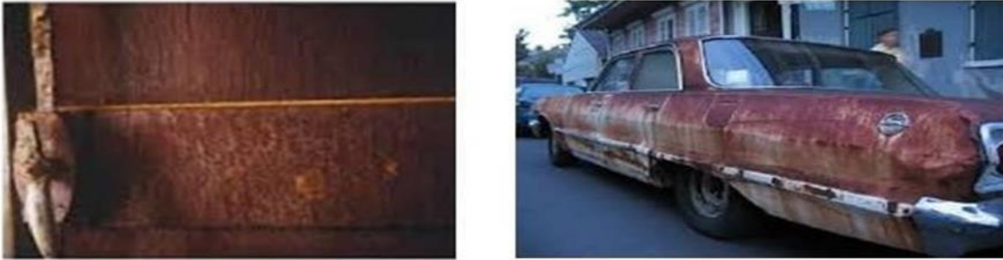
FIGURE II.1: Corrosion générale (rouille) d'une pièce en acier
