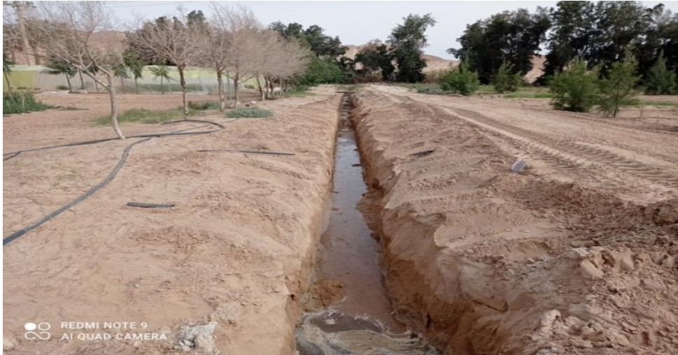
Photo 05 : canal de drainage pour la zone d'expérimentation
