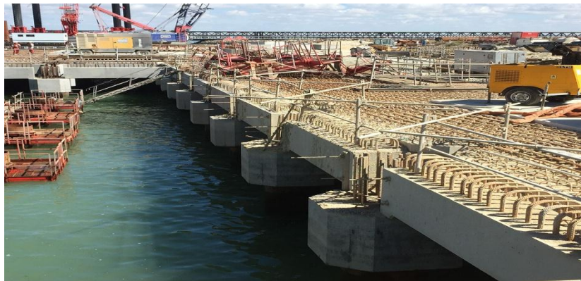
Figure 3.3 : Ouvrages hydrauliques (Keller France).
