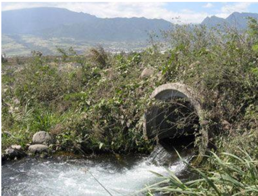
Figure VII.4. Buses en béton.
