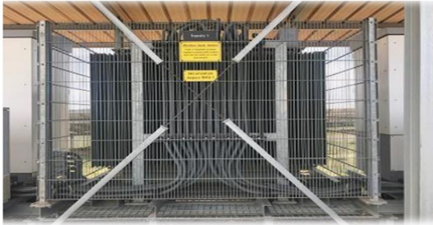
Figure II. 7: Le transformateur de puissance utilisé dans la centrale PV
