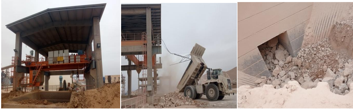
Figure I.6. Le concasseur de calcaire [Photo personnelle].
