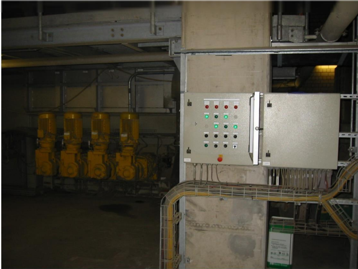
Figure II. 18 : Panneau de commande du concasseur.
