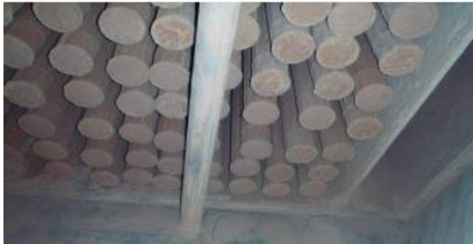
Figure I-26 : Colmatage des filtres
