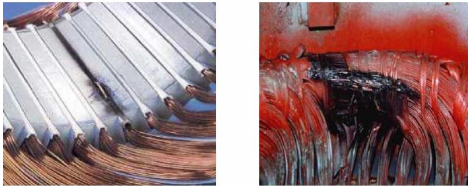
Figure I. 9 : Exemples de dégâts dus au défaut de court-circuit statorique d'un moteur asynchrone
