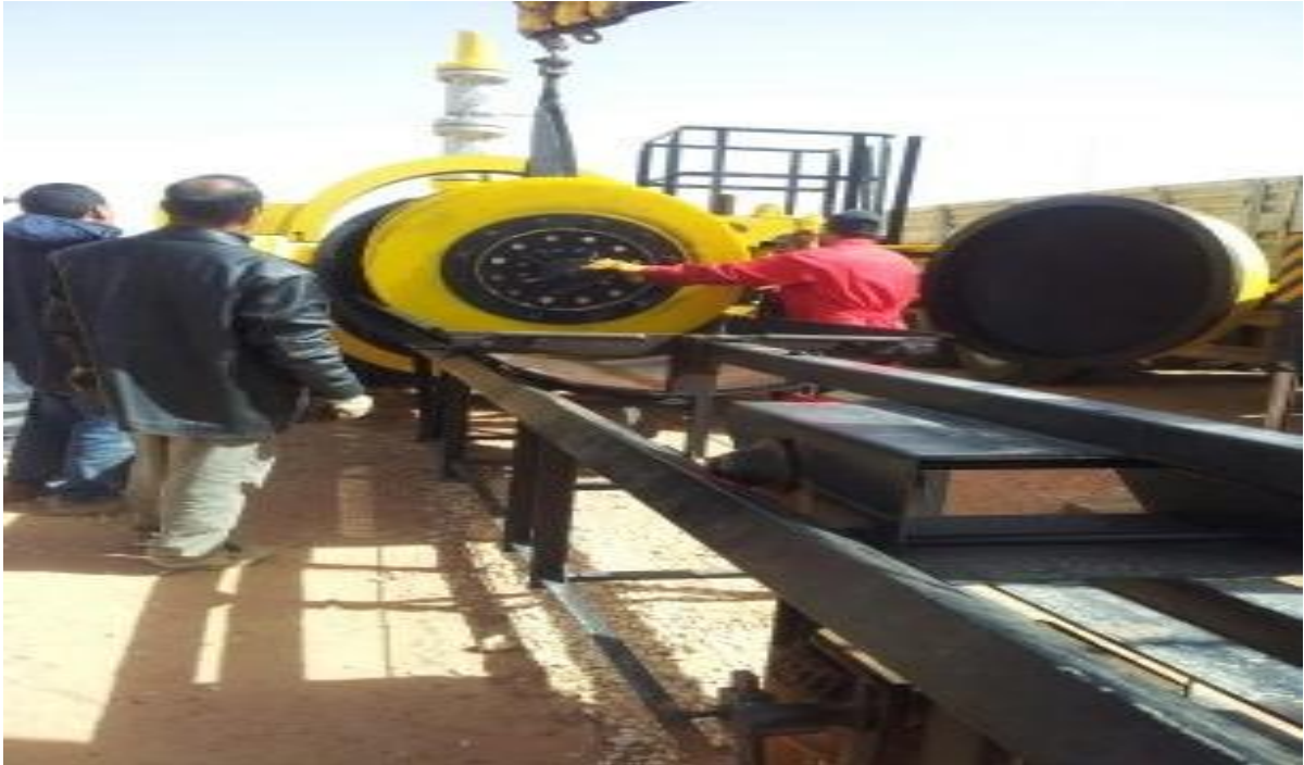
Figure III.5. Image du GRD II est situé dans l'unité RAS ELMIAD de SONATRACH
