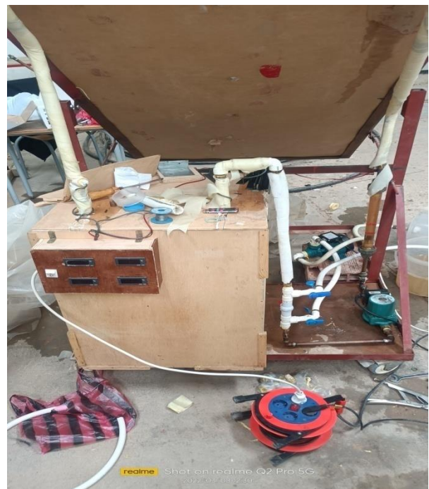
Figure (III.10): Raccordement de la cuve de stockage avec le capteur solaire plan à eau
