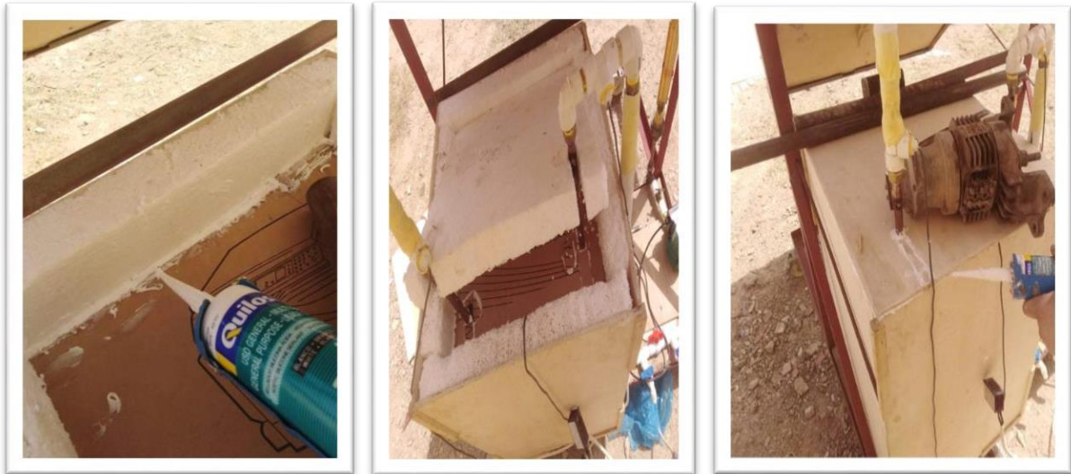
Figure (III.8) : Fermeture de la cuve de stockage et assemblage des éléments par une colle spéciale en silicone.
