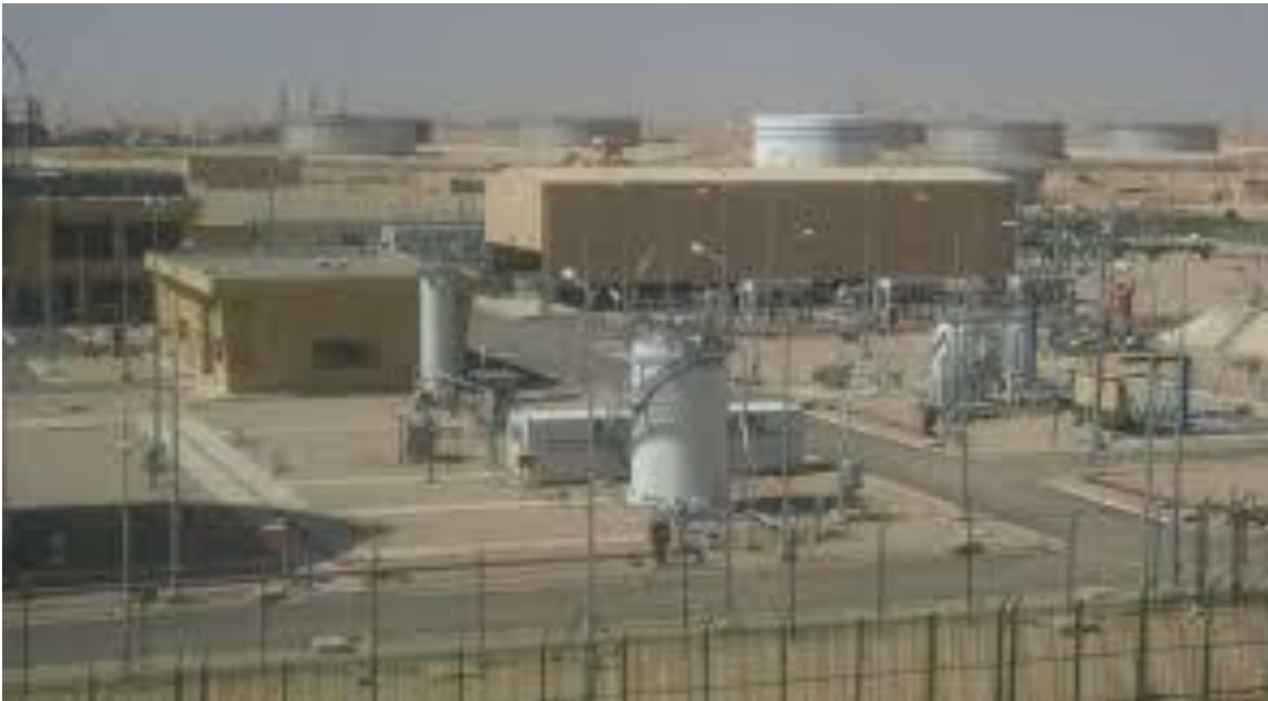
Figure III2 : La station de pompage SP1BIS de Djamaa [19]
