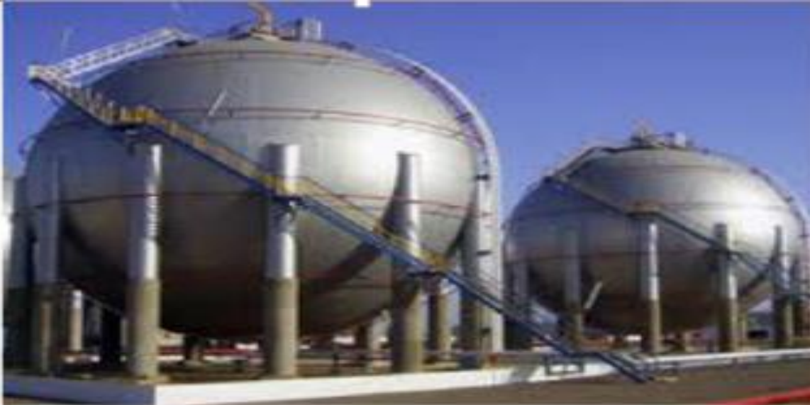
Figure I.6 : Réservoirs sous pression Les sphères.
