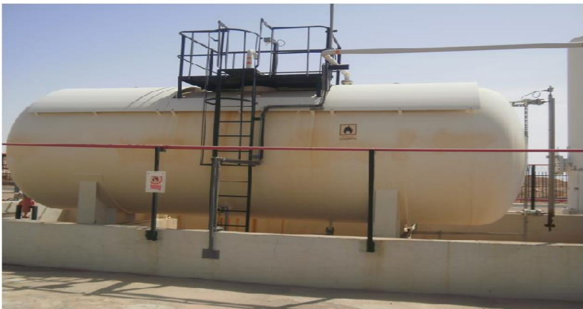
Figure III16 : réservoir de gasoil
