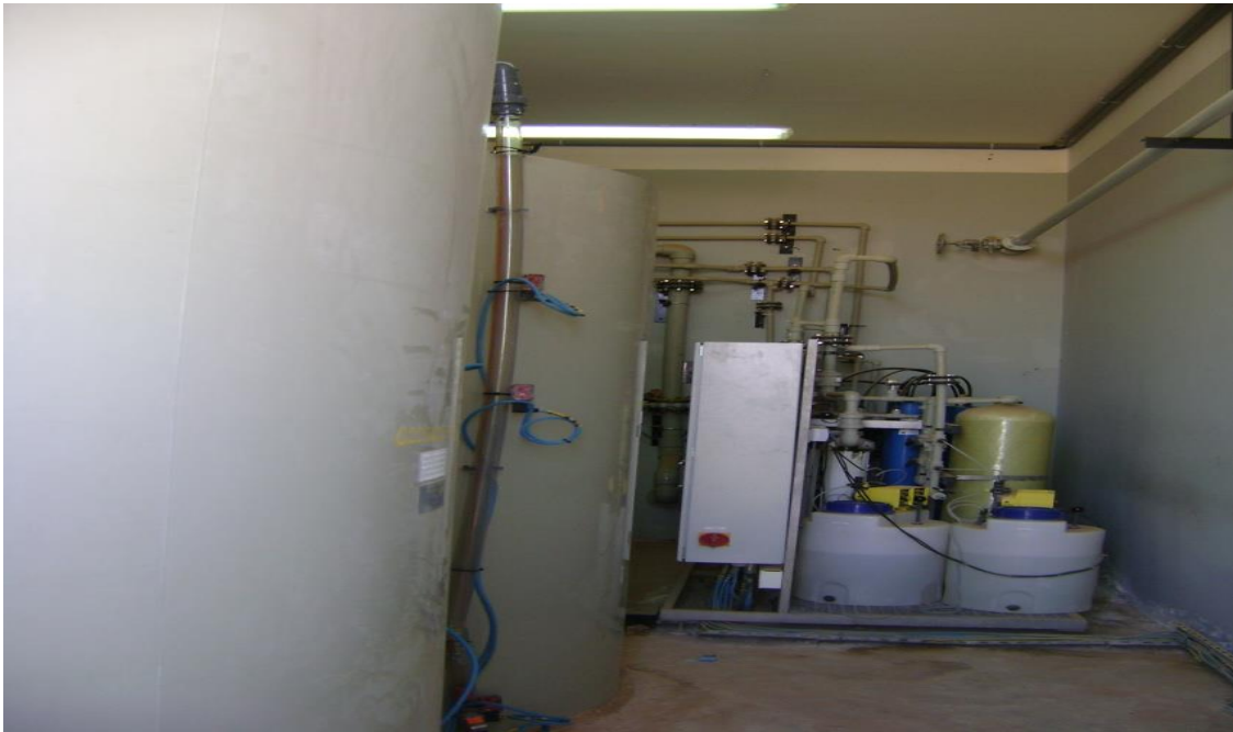
Figure III12 : unité de traitement d'eau
