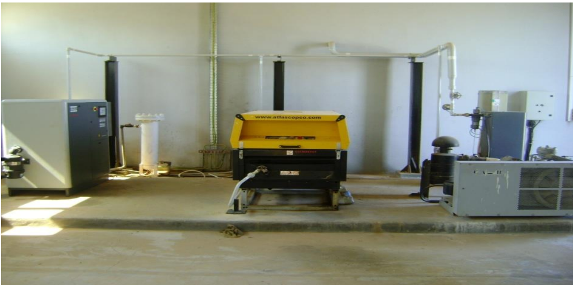
Figure III13 : les compresseurs d'air
