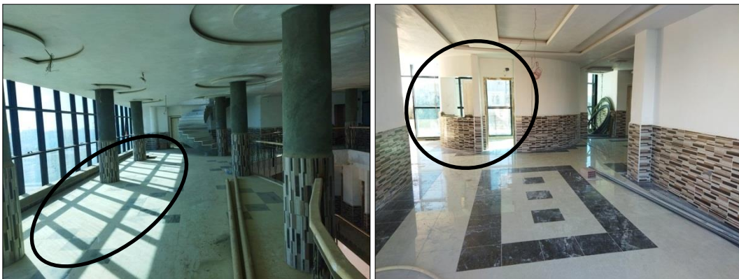
FIGURE : 12 l'éclairage dans halle de DEP de biskra (nouveau) SOURCE : AUTEUR 2021
