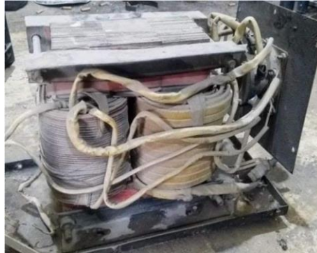
Figure3.1 : transformateur monophasé endommagé
