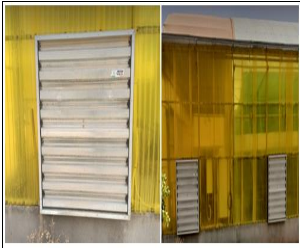
Figure 17 : L'aération de la serre. (Originale, 2022)
