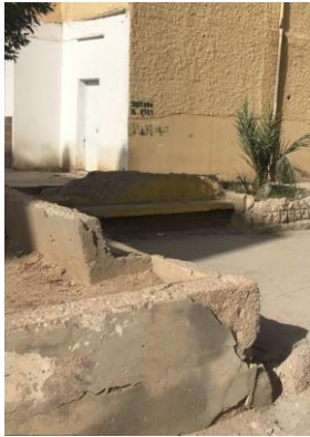
Image 27 : des bancs construits en béton cassés
