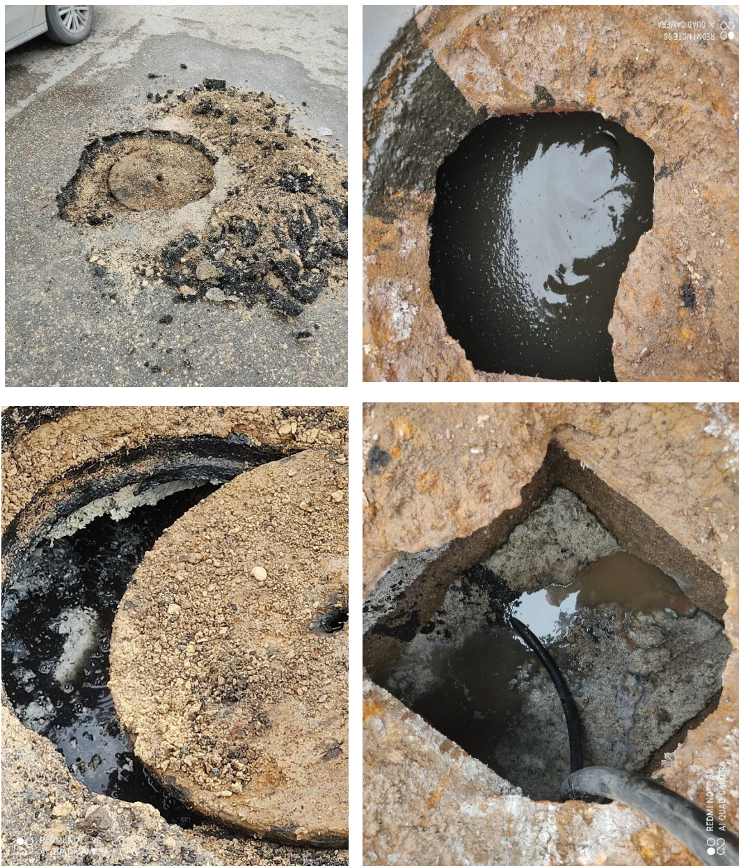
شكل 36: توضح امتلاء قناة بمياه الصرف الصحي وتلوثها
