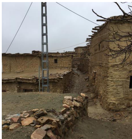
Photo 7 - 10 : Ruelle et maison de la Dechra de Teniet El Abed (Source : Auteur, 2018)
