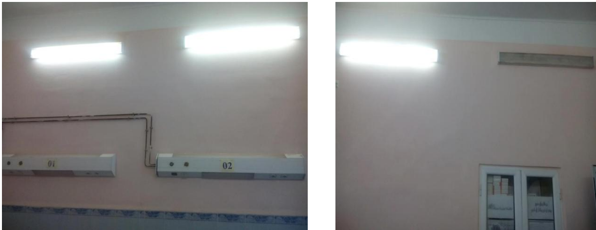
Figure VIII. 58. Photos réalistes montrant les distributions des lampes sur les murs dans une chambre au service pneumo
