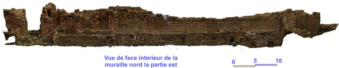
Figure 77 : vue de face intérieur de muraille nord partie est produits par Agisoft photoscan.
