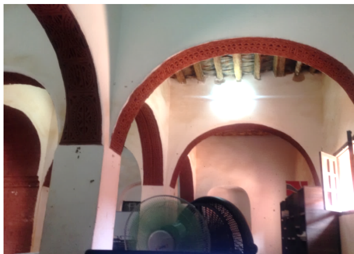
Figure VI- 20. Intérieur de Ex Hôtel Oasis Rouge, construit en 1917, actuellement siège du CAPTERRE. Dans ce bâtiment l'arc est la technique structurelle
