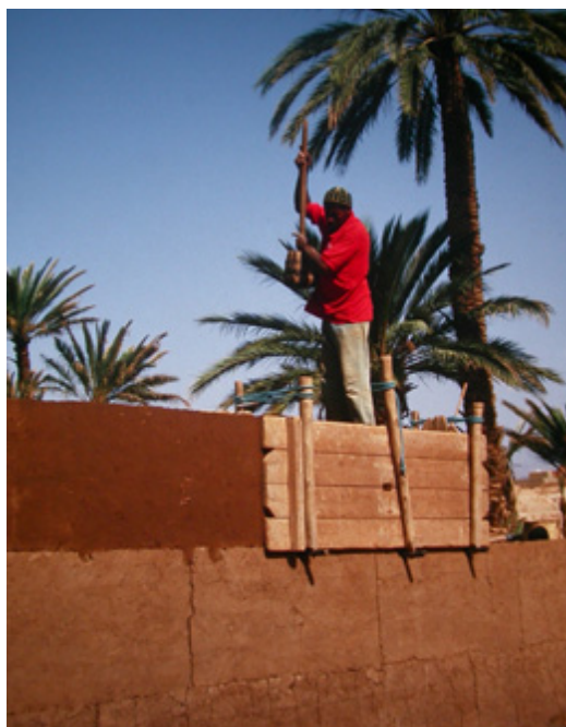
Figure II- 7. Fabrication du pisé traditionnel dans la Vallée du Draa, au Maroc. (Source : Mimó 2014)
