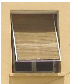
Figure II.36 : protection extérieure mobile. (Source : Auteur, 2017).
