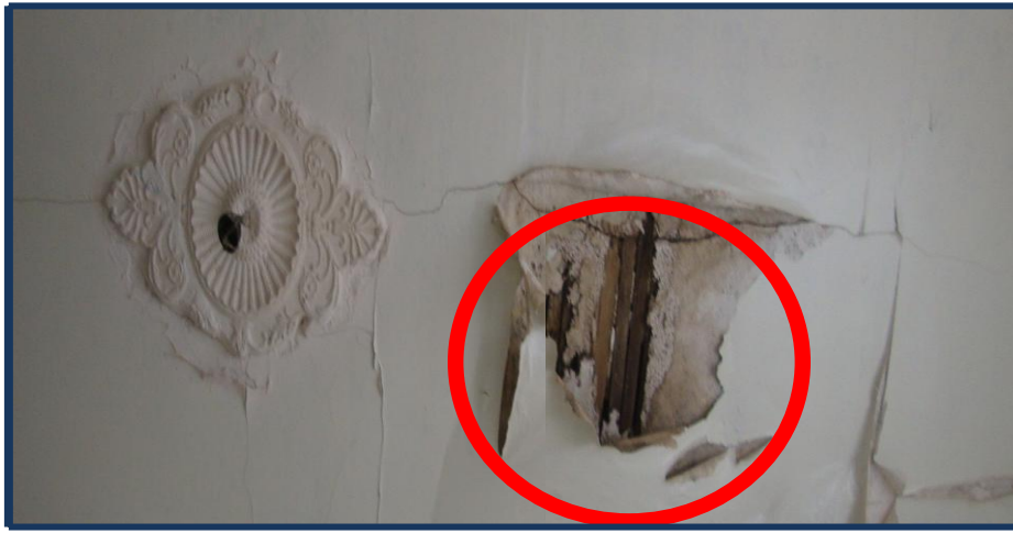
صورة رقم 07-9 احد مشاكل مباني الحقبة الاستعمارية تشقق السقف. المصدر: الباحث.
