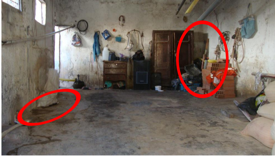
شكل رقم 9-09 احد مشاكل مباني الحقبة الاستعمارية قدم مواد البناء. المصدر: الباحث.
