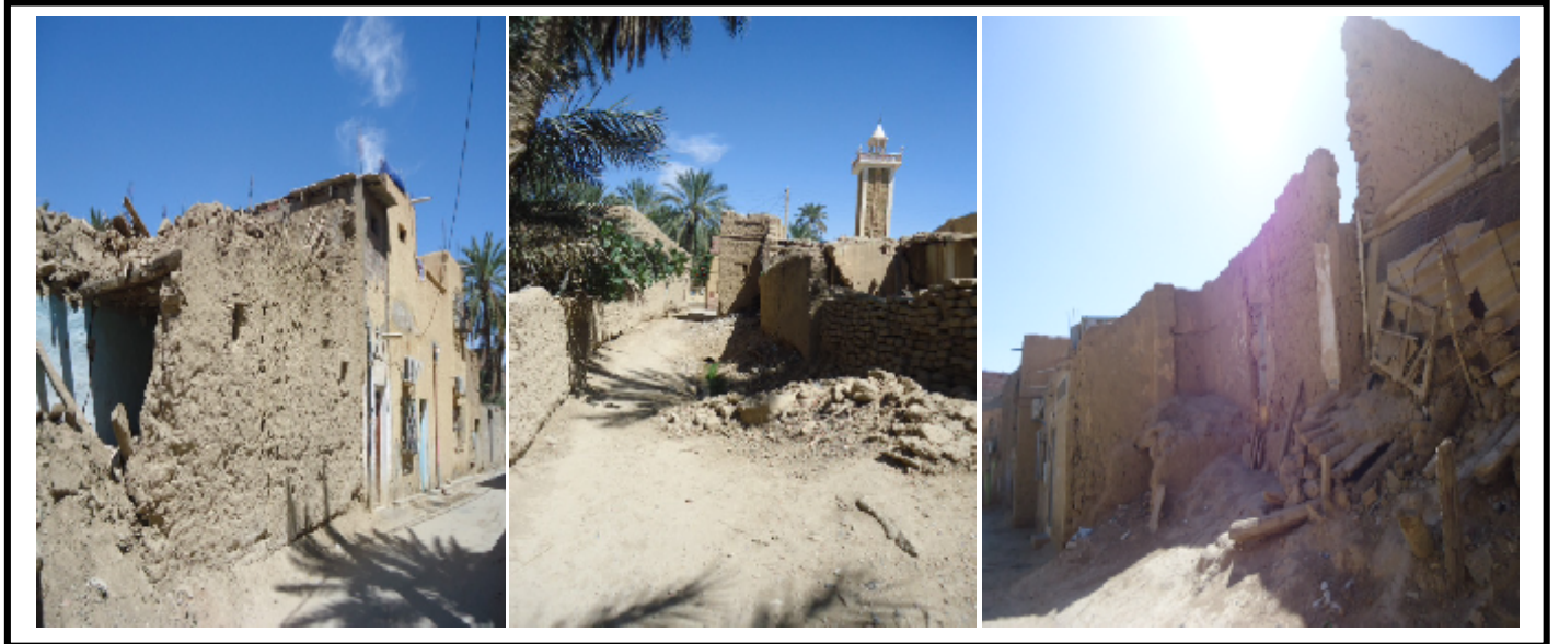
Photos 4-(11, 12,13) : Des constructions délabrées aux quartiers du vieux Biskra « Gueddacha et le Meid)
