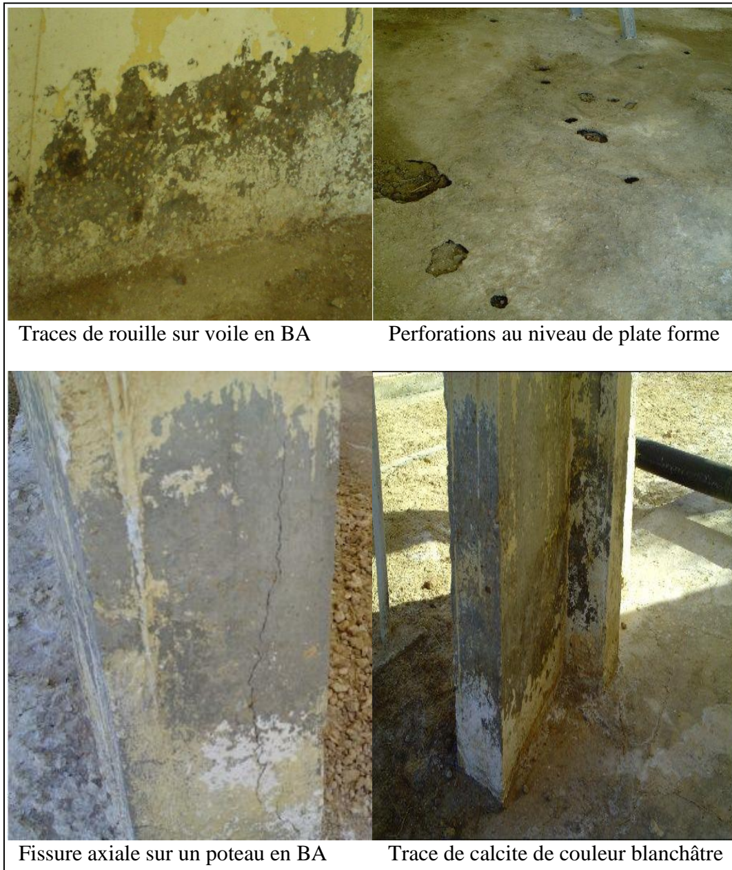
Figure I.2 : Photos illustrent l'effet de la remontée d'eau sur les ouvrages en Béton armé (T.djedid et A. Guettala., 2012).
